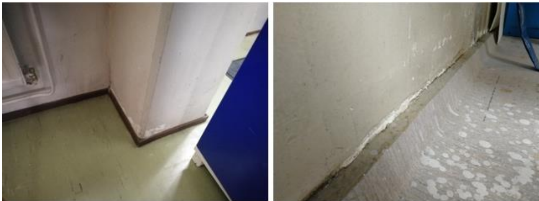
Kuva 15. Työsalin 160 pilarin alareunan ja työsalin 081 vesipisteen alapuolella havaittiin maalin hilseilyä tai kulumaa. Kohdissa ei havaittu pintakosteusilmaisimen kohonneita lukemia.
