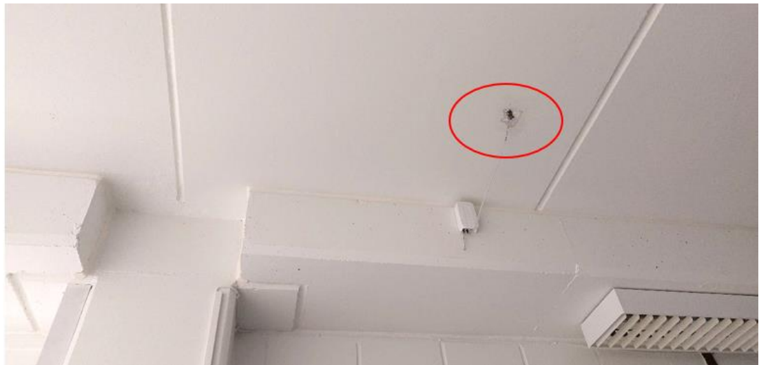
Kuva 26. Tilan opettajat 077 merkkiainekokeessa havaittiin yksi ilmavuotokohta 720°-yrityksen paine-eromittarin läpiviennin kohdalla. Yläpohjan joustavat saumamassaukset olivat hyväkuntoisia.
