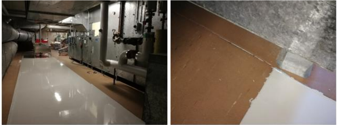
Kuva 8. Yleiskuva IV-konehuoneen välipohjasta. Konehuoneen muovimatto on paikkakorjattu pinnoitteella kohdassa, jossa aiemmin on havaittu kohonnutta kosteutta muovimaton alla. Muovimaton saumat olivat avonaiset useasta kohdasta. Viereisen IV-koneen alta puuttuu lattiakaivo.
