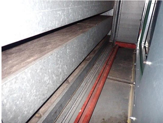
Kuva 36. Yleiskuva TK1 tuloilmakoneen puhaltimen jälkeisestä äänenvaimentimesta. Äänenvaimentimet ovat suojattu lasikuitukankaalla, mutta se on paikoin hieman revennyt. ÄV-kammioiden äänenvaimennuseristeet on poistettu tai vaihdettu polyesterikuitumateriaaliin.
