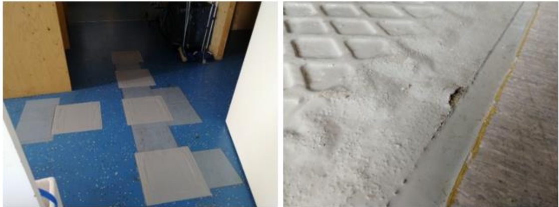
Kuva 4. Alapohjan tarkastusluukkuja on tiivistetty massamaisella tiivistysmateriaalilla ja vahvikenauhoilla. Tiivistyksissä on paikoitellen pieniä mekaanisia vaurioita, mutta pääasiassa ne olivat hyväkuntoisia.
