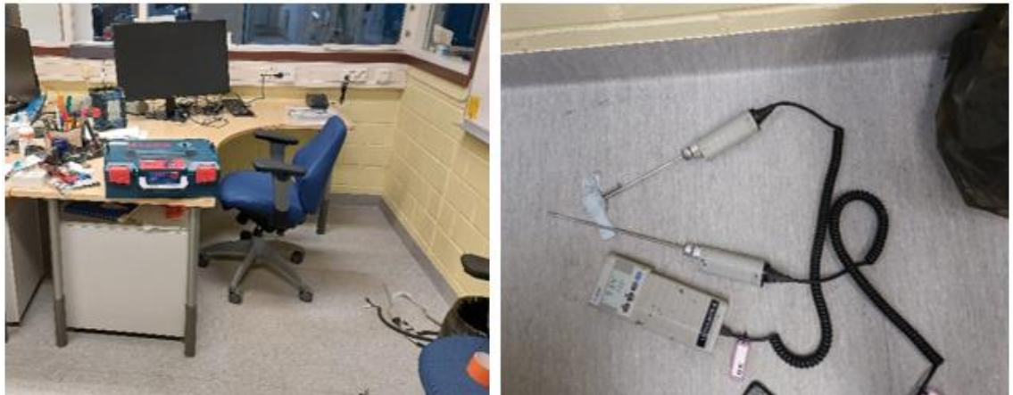
Kuva 7. Viiltomittaus (V8, 93,4 %RH) opettajaintilasta 159. Mahdollisesti tilaan on asennettu epoksi ja kohonnut kosteus mitattiin epoksin ja muovimaton välistä.
