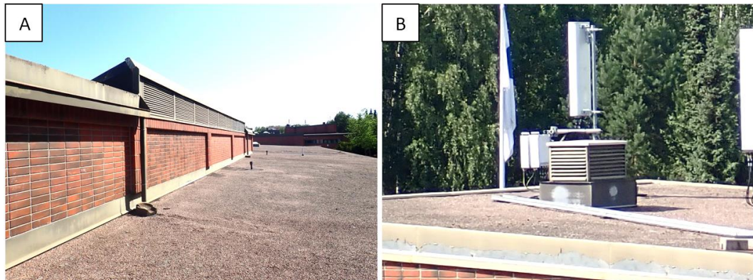
Kuva 28a ja b. Yleiskuvat ulkoilmanotosta (oikeanpuoleinen kuva) ja ulospuhalluksesta (vasemmanpuoleinen kuva).
