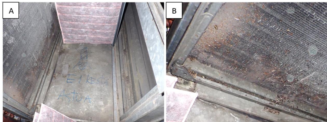
Kuva 33a ja b. Yleiskuva iv-koneiden tuloilmasuodatinkammioista. Suodatinrungot ovat osin epätiivittä ja silmämääräisesti arvioiden niiden osittainen ohivuoto likaannuttaa pattereita, jotka ovat osin tukossa (vasemmanpuoleinen kuva). Kammioiden pohjilla on jälkiä seisoneesta vedestä. Tuloilmasuodattimien suodatinluokka on yleisesti ePM1 65 % (F7). Huoltomerkintöjen mukaan suodattimia on vaihdettu 1–2 krt/vuosi.
