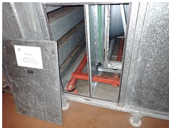
Kuva 35. Iv-koneiden puhaltimet on saneerattu suoravetoiseksi. Puhallinkammiot olivat hieman likaisia.
