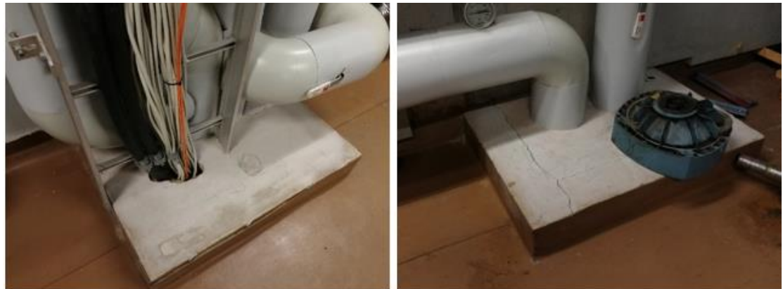
Kuva 9. IV-konehuoneen sähköjohtojen läpivienti on tiivistetty mineraalivillalla. Yhdessä läpiviennin betonivalussa on halkeama. Läpiviennistä ja halkeamasta havaittiin ilmavirtaus konehuoneeseen päin merkkisavulla, eli käyttötilat ovat ylipaineiset ilmanvaihtokonehuoneen suhteen.
