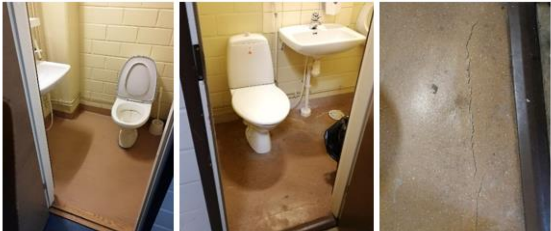
Kuva 3. WC-tilojen pintamateriaaleina on alkuperäinen märkätilan muovimatto tai akryylibetoni. Akryylibetonissa on halkeamia.
