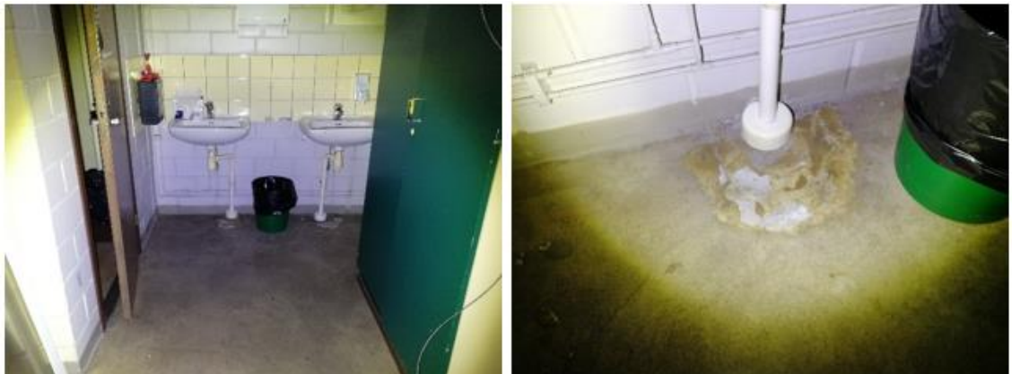
Kuva 5. Työsalin 160 vesipisteen alapuolella pinnoite on irtoillut ja betonipinta on näkyvillä. Alkuperäisessä pinnoitteessa on useassa kohdassa kulumia/vaurioita.
