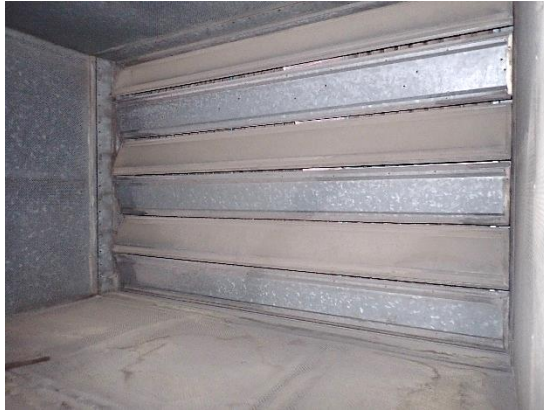
Kuva 32. IV-koneen 01 TK ulkoilmapelti ei sulkeudu täysin kiinni koneen seis- tilassa.
