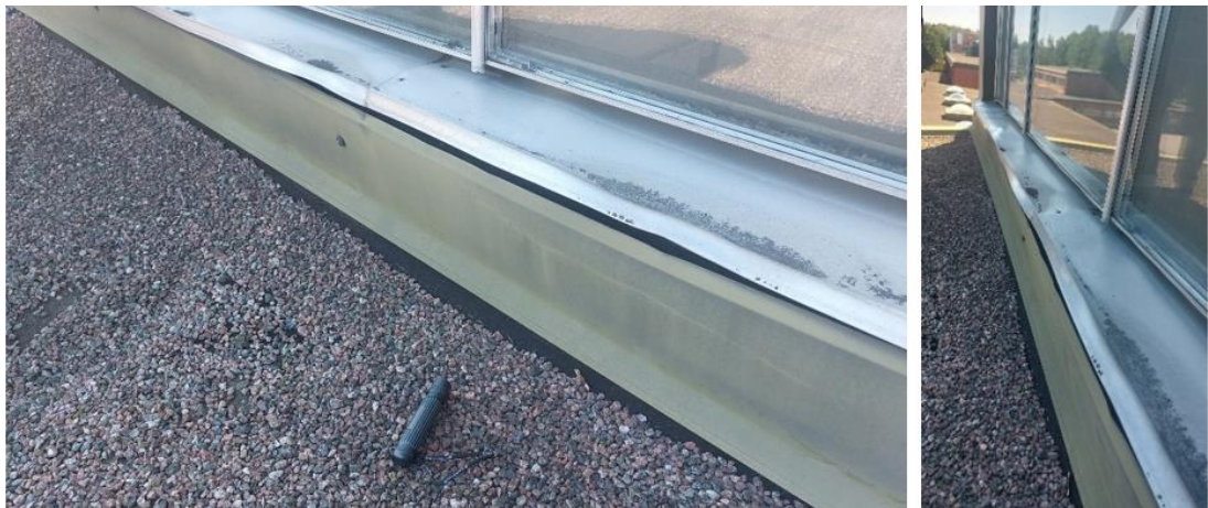
Kuva 25. Vääntyneen pellityksen raosta sadevesi pääse rakenteisiin.
