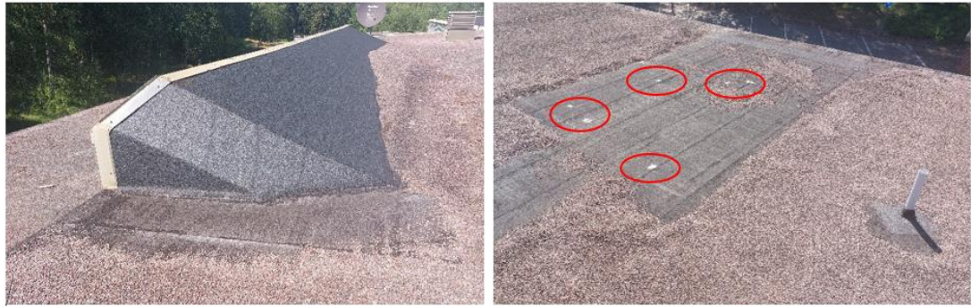
Kuva 24. Katolla oli tehty useita paikkakorjauksia bitumikermeillä sekä siveltävillä tiivistysaineilla. Kuvat käytöstä poistettujen tilojen yläpuolelta.
