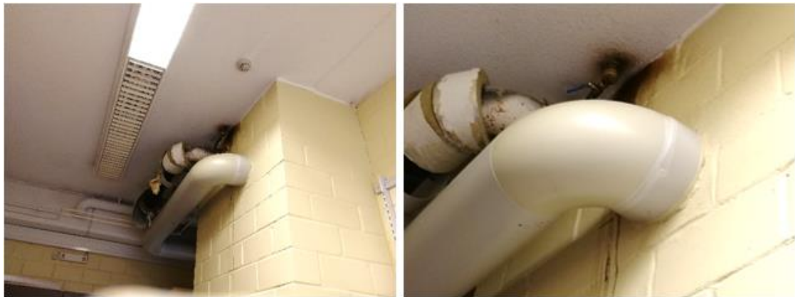
Kuva 27. Opetusvälinevarastossa 422 vesiputki on vuotanut aiemmin (nyt kuiva). Kohdasta on poistettu osa putkieristeitä.
