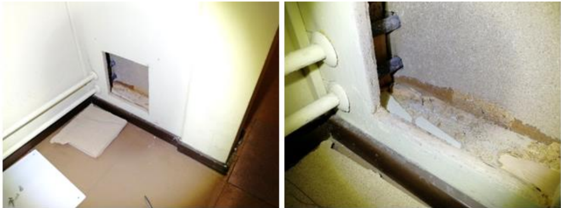
Kuva 28. Tutkimuksessa avattiin (RA14) Inspecta Oy vuoden 2019 tutkimuksessa tehdyn avauksen suojapellitys luokassa 424-427. Inspecta Oy:n havaitsemia kosteusjälkiä ei ole korjattu väliseinässä.
