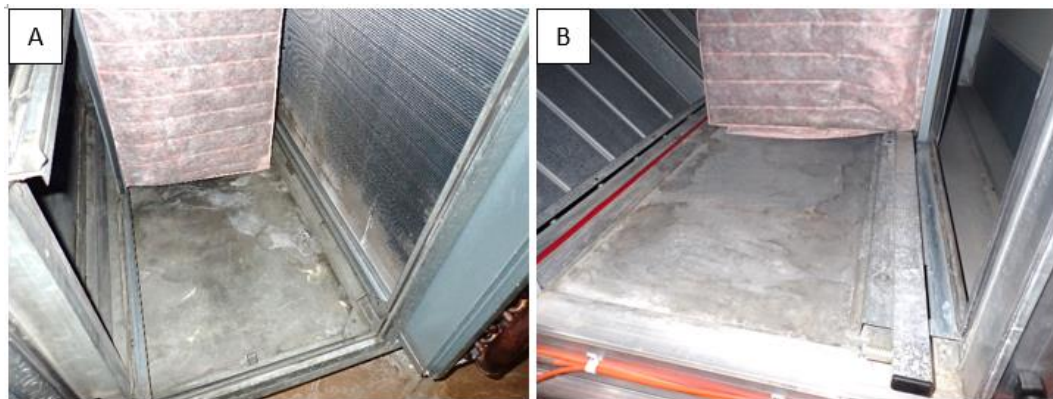
Kuva 44a ja b. Yleiskuva iv-koneiden tuloilmasuodatinkammioista. Suodatinrungot ovat osin epätiivittä ja silmämääräisesti arvioiden niiden ohi pääsee likaa koneen sisäosiin. Kammioiden pohjilla on jälkiä seisoneesta vedestä. Tuloilmasuodattimien suodatinluokka on yleisesti ePM1 65 % (F7). Huoltomerkintöjen mukaan suodattimia on vaihdettu 1–2 krt/vuosi.
