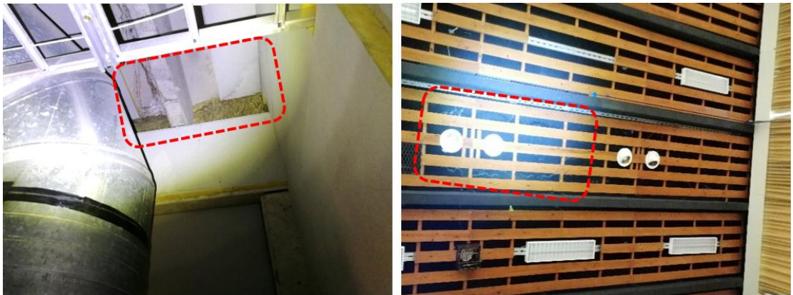
Kuva 35. Vuotojälkiä liikuntasalin IV-konehuoneen (IVKH 1) ja liikuntasalin katossa akustiikkalevyissä, ympyröity punaisella.
