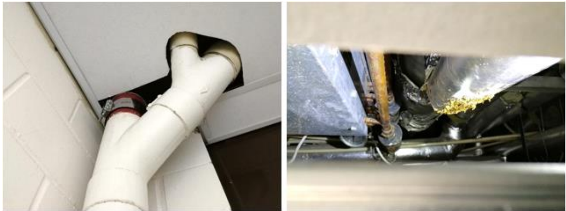
Kuva 12. Tuulikaapissa 169 Inspecta Oy:n vuoden 2019 tutkimuksessa havaitsema viemäriputken vuoto on korjattu. Samassa tilassa havaittiin kuitenkin toinen eristetyin putken kohta alakattotilassa, jossa oli vuotojälkiä. Kohdasta ei havaittu aktiivista vuotoa.
