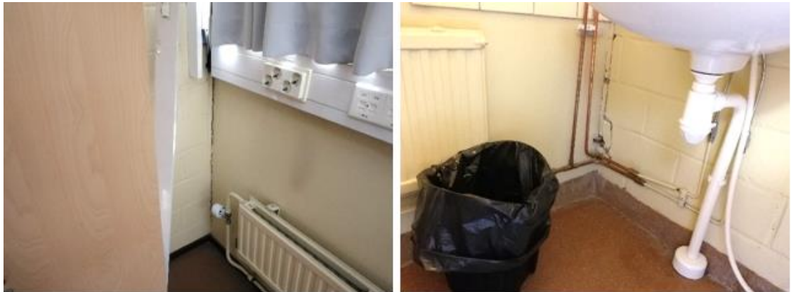
Kuva 24. Väliseinien ja ulkoseinän liitos on haljennut useissa tiloissa.
