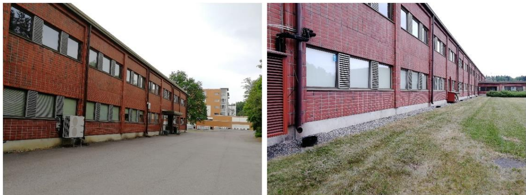
Kuva 18. Yleiskuvat eteläsiiven länsisivusta (vasen kuva) ja itäisivusta (oikea kuva). Syöksytorvien roiskevesi on aiheuttanut länsisivua
