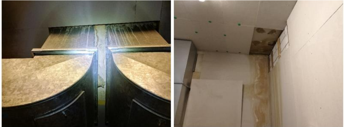
Kuva 34. Vuotojälkiä länsisiiven (IVKH 2) ja eteläsiiven (IVKH 3) IV-konehuoneissa.
