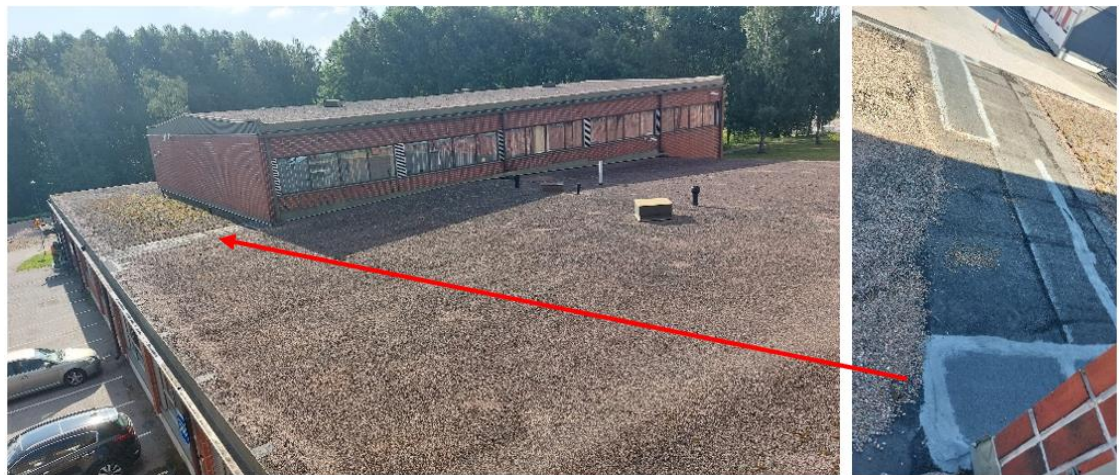
Kuva 30. Ruokalan ja liikuntasalin vesikatot sekä paikkakorjaus. Räystäällä näkyy räystäskourupellin jatkoskohtiin bitumikermillä tehtyjä paikkakorjauksia. Näitä on tehty kaikille räystäille. Kuvassa 33 lähikuva paikkakorjauksesta.
