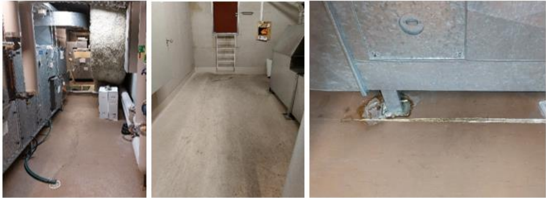
Kuva 11. Yleiskuva eteläsiiven IV-konehuoneiden välipohjista. IV-konehuoneiden muovimatoissa on avonaisia saumoja.
