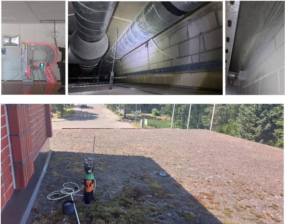
Kuva 37. Eteishallissa havaittiin ilmavuotoa yläpohjasta merkkianekokeessa välittömästi, kun alipaineistuslaite käynnistettiin. Merkkiaine laskettiin yläpohjaan vesikatolta alipainetuuletusventtiilin kautta.
