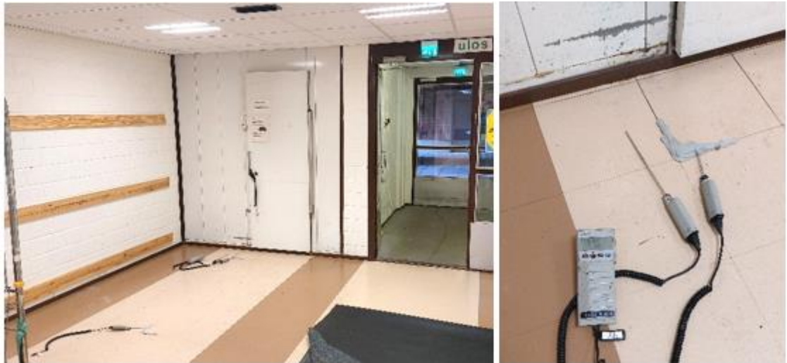
Kuva 8. Viiltomittaus (V1, 94,9 %RH) käytävältä 230 jätekyliön edestä. Kylmiön edustalla oli mikrobiperäistä hajua ja väliseinän maalipinnan kupruilua.
