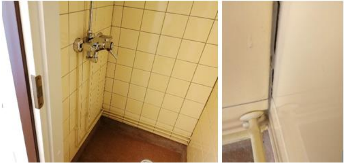
Kuva 26. 2. kerroksen suihkuhuoneessa 490 väliseinän ja ulkoseinän liitos on haljennut ja kohdan saumamassa on ratkennut suihkun vieressä.
