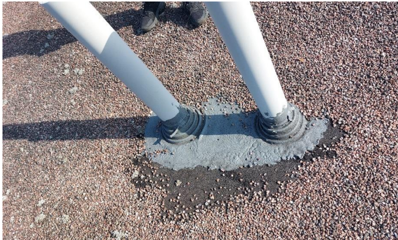
Kuva 31. Läpivientejä on tiivistetty paikoin ja katolla on tehty useita paikkakorjauksia tiivistysmassoilla.
