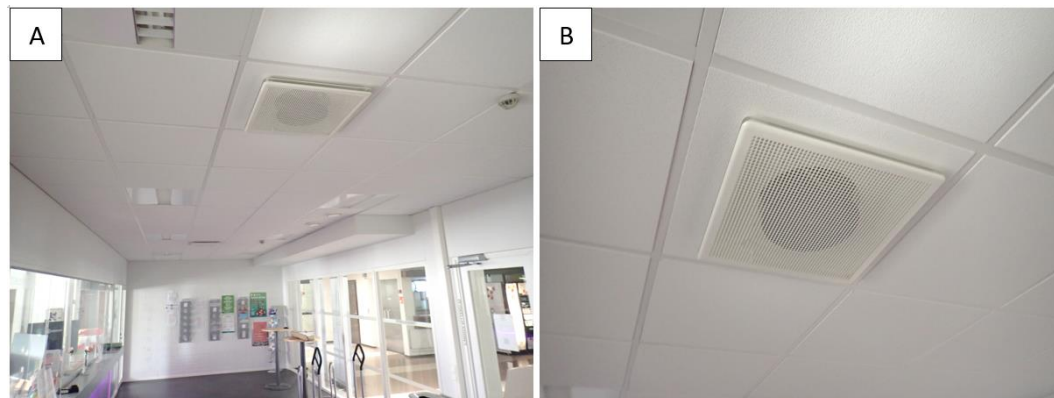
Kuva 56a ja b. Yleiskuvat uudemmissa tuloilmapäätelaitteista.
