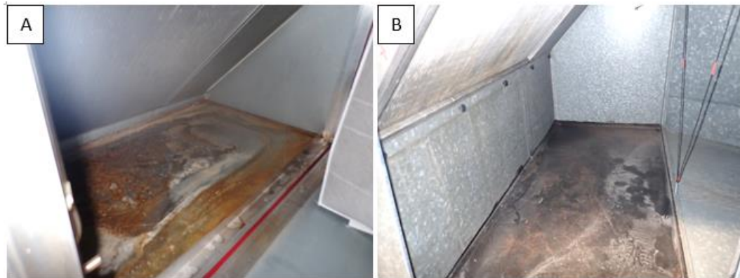
Kuva 46a ja b. Yleiskuvat iv-koneiden lto-osista (vastavirtakenno). Kammioiden pohjilla on jälkiä seisoneesta vedestä ja lisäksi paikoin korroosiota. Osa pohjista on mahdollisesti käsitelty/pinnoitettu mustalla aineella (oikeapuoleinen kuva). Mahdollisesta pinnoitteesta ei havaittu hajua.
