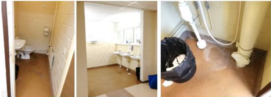
Kuva 4. WC-tilojen pintamateriaaleina on akryylibetoni. Akryylibetonissa on valkoista kalkkihärmää useimmissa märkätiloissa.
