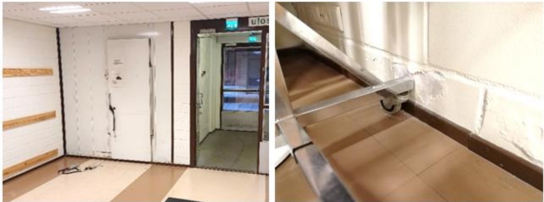
Kuva 25. 1. kerroksen jätekylmiö 247. Väliseinän maali hilseilee suolojen kertymän takia jätekylmiön viereisessä pesulatilassa 248 kylmiön vastaisessa seinässä. Pintakosteusilmaisimen lukema kohdassa oli 120. Myös juureskylmiön 213 vastaisessa väliseinässä käytävässä 230 seinän maalipinta hilseilee alareunasta.
