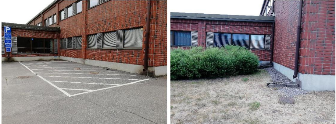
Kuva 19. Syöksytorvien ja räystäskourujen saumavuotojen aiheuttamaa kosteusrasitusta ulkoseinän sokkelilinjailla on myös pohjoissiiven (vasen kuva) ja liikuntasalisiiven (oikea kuva) julkisivuilla.
