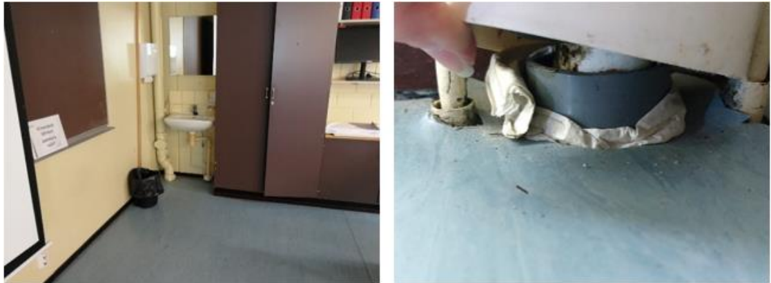
Kuva 13. Luokassa 476 oli viemärinhajua, jonka lähteeksi epäiltiin nurkan viemäriputkea. Yläpohjan merkkiainetutkimuksissa viemäriputki osoittautui tiiviiksi, ja hajun lähteeksi paljastui käsienvesualtaan epätiivis välipohjan viemäriiliitos (kuvassa oikealla).
