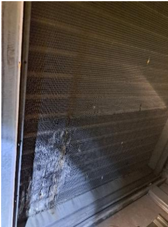
Kuva 110 Lämmönsiirtimen vauriokohta koneessa 3TP.
