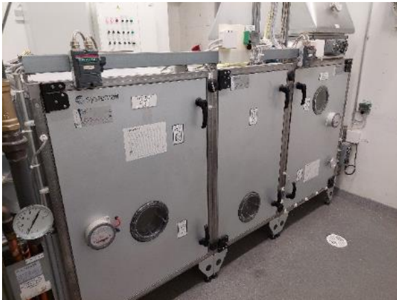
Kuva 102 IV-kone TK51, yleiskuva.
