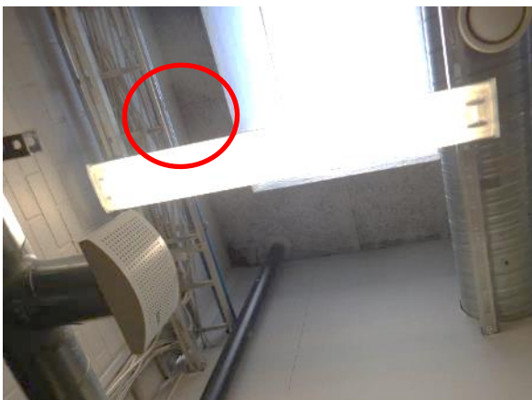
Kuva 73 Ilmastointiasentajien tilassa B136 oleva kattoikkuna. Kattoikkunan läheisyydessä mahdollisia vesivuotojälkiä.
