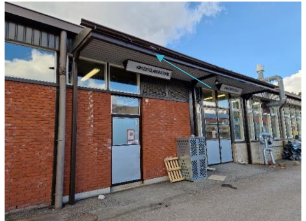
Kuva 82 Myös B-siiven pohjoispuolen sisäänkäyntilippojen kohdilla sadevesikouruissa esiintyy vuotokohtia/reikiä.
