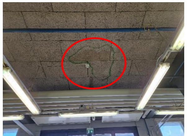
Kuva 74 Vesivuotojälki Koneistamon B141 katossa.
