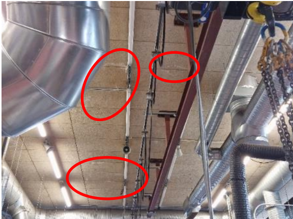
Kuva 75 G-laajennuksen työsalin yläpohjassa esiintyy vesivuotojälkiä.
