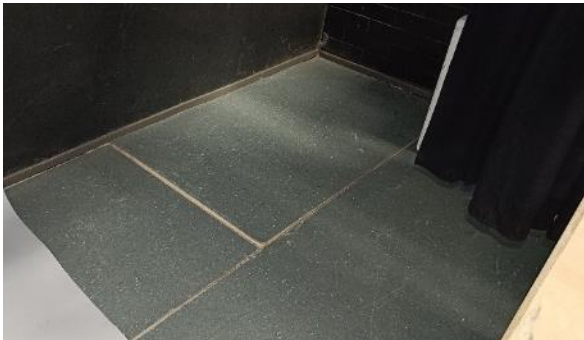
Kuva 89 Studio A170 lattiakanaalissa on levyrakenteinen epätiivis kansi.
