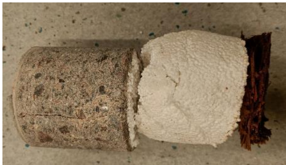
Kuva 9 EPS-eristeen alla on kosteus- ja mikrobivaurioitunut vaneri.
