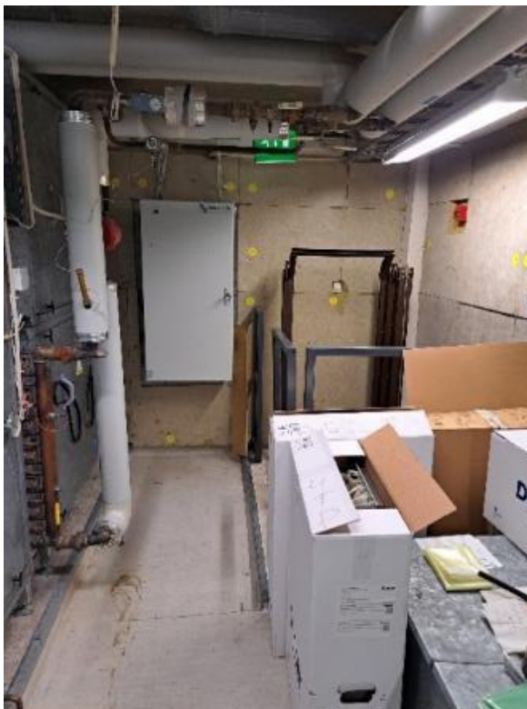
Kuva 106 Yleiskuva A1-osan IV-konehuoneesta.
