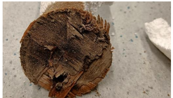
Kuva 10 EPS-eristeen alla on kosteus- ja mikrobivaurioitunut vaneri.
