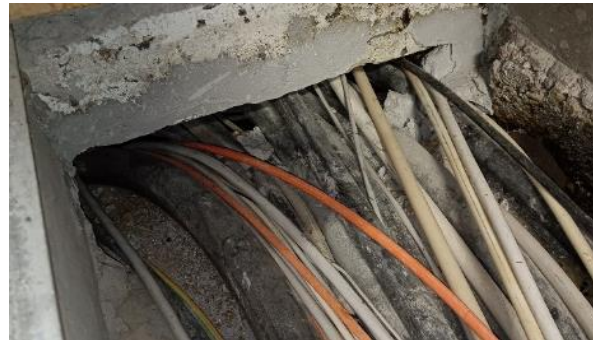
Kuva 90 Studio A170 lattiakanaali.
