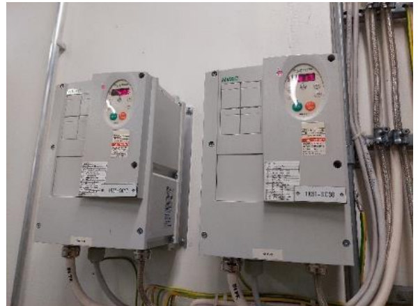
Kuva 103 Koneita ohjataan taajuusmuuntajilla.
