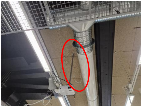
Kuva 71 Työsali A168. Salin katossa vesivuotojälkiä. Ko. kohdan vaurioituneet alakatolevyt on uusittu kesällä 2023.
