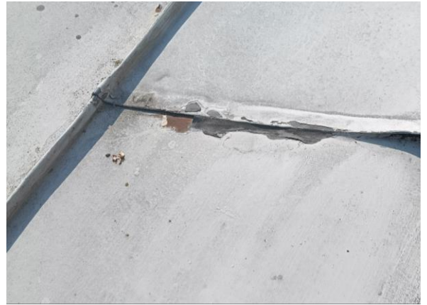
Kuva 80 Pellin saumoja on tiivistetty paikoin massalla.
