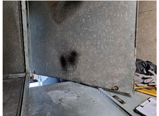
Kuva 109 Tulopuhallinkammion ovesa (1TP) on mustaa likaa.
