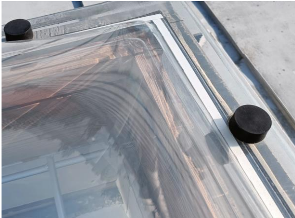
Kuva 77 Savunpoistoluukun puurakenteessa on kosteusvauriojälkiä.
