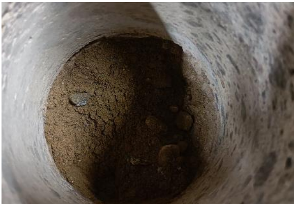
Kuva 42 Alapohjana oli lämpö- ja kosteuseristämätön betonilaatta.
