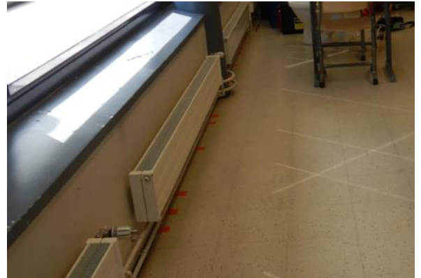
Kuva 23 Luokkahuoneen B155 ikkunaseinustalla merkittävää ilmaavuotoa seinän ja lattian liittymässä sekä pilarin juuressa.
