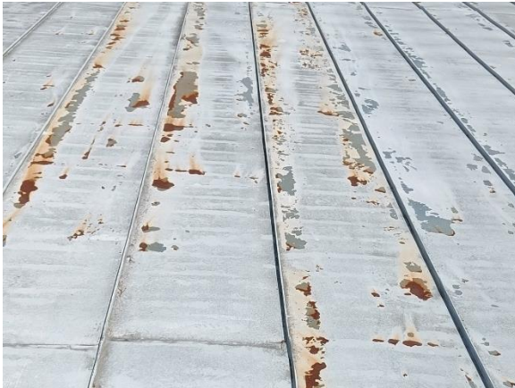
Kuva 79 Pellin maali on monin paikoin irronnut ja pellissä on ruostetta.
