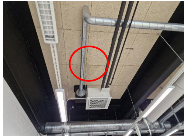
Kuva 72 Työsali A168. Salin katossa vesivuotojälkiä.
