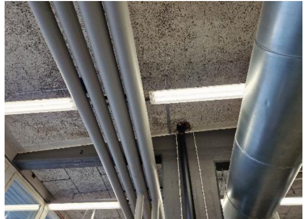
Kuva 78 Yläpohjarakenteessa on havaittavissa epätiiviyttä tai mineraalivillalla tilkittyjä läpivientejä.
