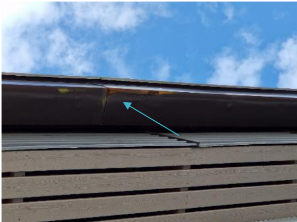
Kuva 81 G-laajennusosan sadevesikouruissa esiintyy vesivuotokohtia.
