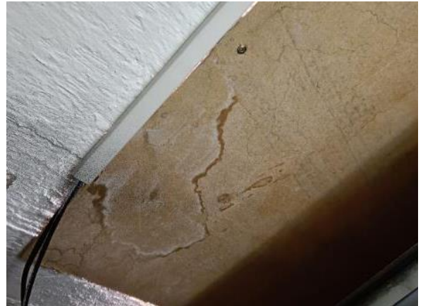
Kuva 76 Studion A170 alas lasketun katon yläpuolella olevassa kattoikkunaa peittävässä levyssä on vesivuotojälkiä.
