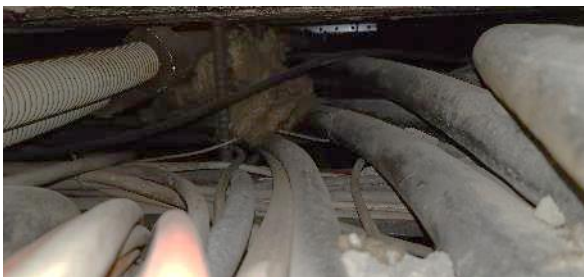
Kuva 91 Studio A170 lattiakanaalissa on mineraalivillaa.
