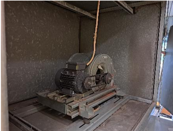
Kuva 108 IV-koneen 1TP puhallin.
