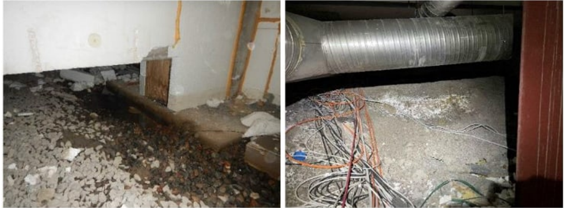
Kuva 170. Alustäytössä on monin paikoin märkiä alueita, kalkkihärmettä ja irtovettä.
