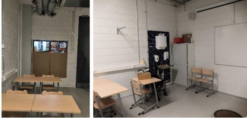
Kuva 198. Vanha trukkihuoltotila 1086 (107) on muutettu opetustilaksi. Tilan ovi viereiseen hallitilaan 1085 on epätiivis, oven alta on suora yhteys halliin.
