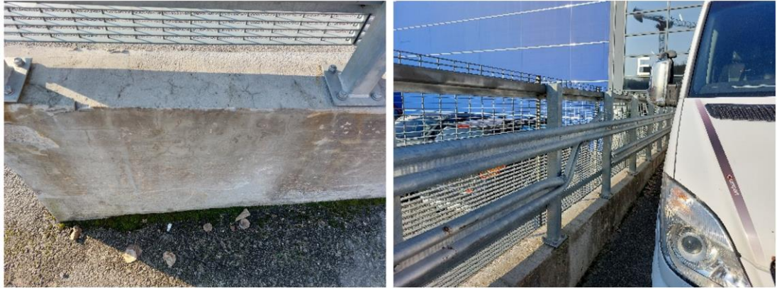
Kuva 146. Rakennuksen itäsivun pohjoispäädyn betonirakenteisessa aidassa havaittiin alkavaa rapautumishalkeilua, sekä teräskaiteen paikallinen vaurio.
