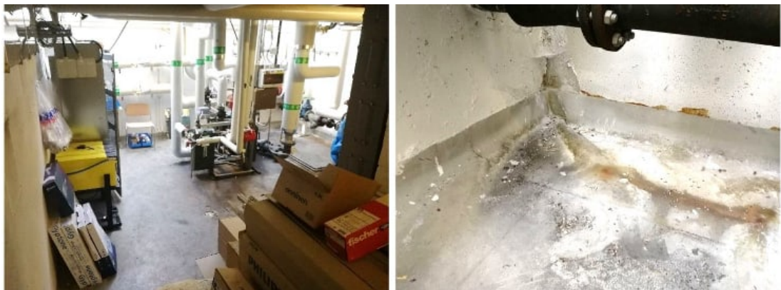
Kuva 23. Lämmönjakohuoneessa märkätilan muovimatto on irti alustastaan, rikki ja sen ylösnostoissa on puutteita. Nurkkakohdissa on
