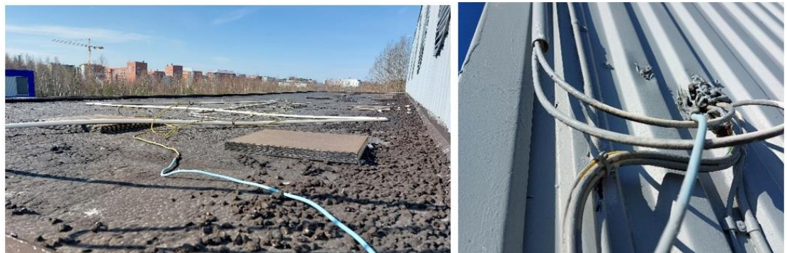
Kuva 100. Länsipuolella rakennusta sijaitsevan IV-konehuoneen bitumikermikatto. Katolle ei ollut pääsyä, mutta reunalta pystyi havainnoimaan kattoa, jossa lojui sähköputkia, johtoja sekä vaneria. Seinän puutteellisesti tiivistetty läpivienti on todennäköisesti aiheuttanut vuotojäljet IV-konehuoneessa.
