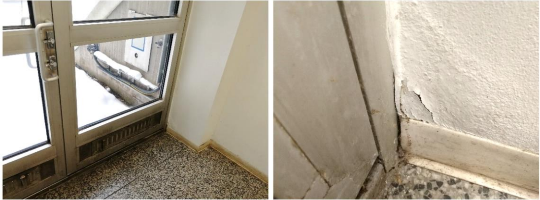
Kuva 64. Kosteusvauriojälkiä pilarin alaosassa porrashuoneen 127 oven vieressä.
