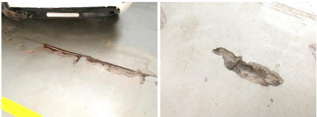
Kuva 20. Hallien alapohjan pinnoite pinta on mekaanisen rasituksen takia pinnasta kulunut ja betonipinta on rikki useassa kohdassa.
