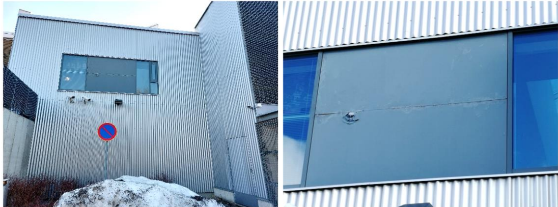
Kuva 67. Tilojen 2008 ja 2007 ulkoseinärakenteita on uusittu laajennusosan rakennuksen yhteydessä. Ikkunoiden välisen levytetyn osan pinnassa on kosteusjälkiä ja maali hilseilee.
