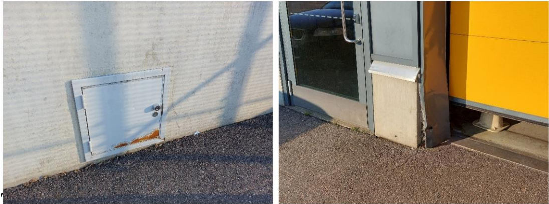
Kuva 192. Ryömintätilan eteläpäädyn kulkuluukun pinta on ruostunut. Hallien nosto-ovien pellitys on vaurioitunut mekaanisesti kahdessa kohdassa.
