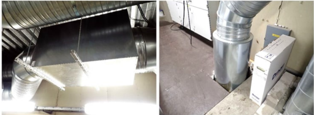
Kuva 132. Yleiskuvia iv-konehuoneiden äänenvaimentimista.
