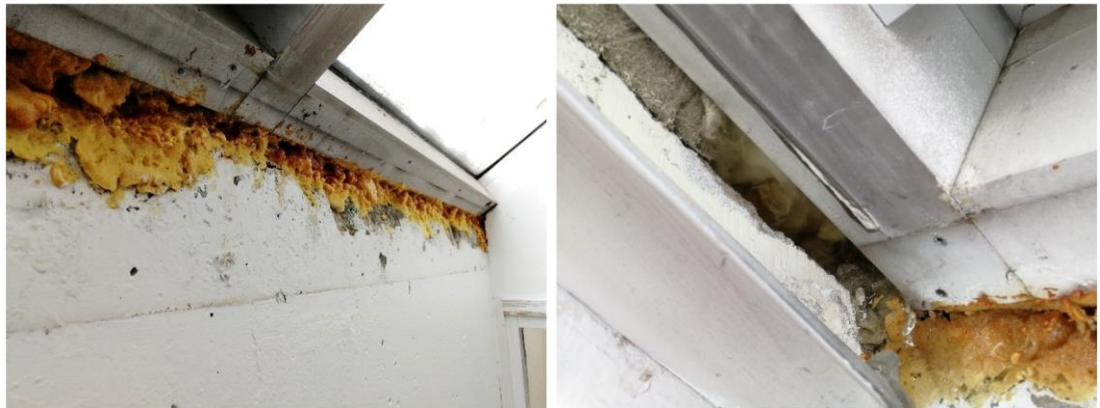
Kuva 27. Ulkoseinän ja vinojen ikkunoiden vaakaliitoksissa on tiivisteinä polyuretaanivaahtoa. Ulkonurkassa ulkoseinän ja vinon ikkunan pystyliitoksessa on mineraalivillaa. Liitokset ovat epätiivitä.
