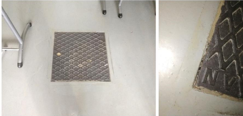
Kuva 21. Alapohjassa on vanhoja luukkuja, jotka on tilaajalta saadun tiedon mukaan betonoitu umpeen. Luukkujen saumat olivat kuluneet.
