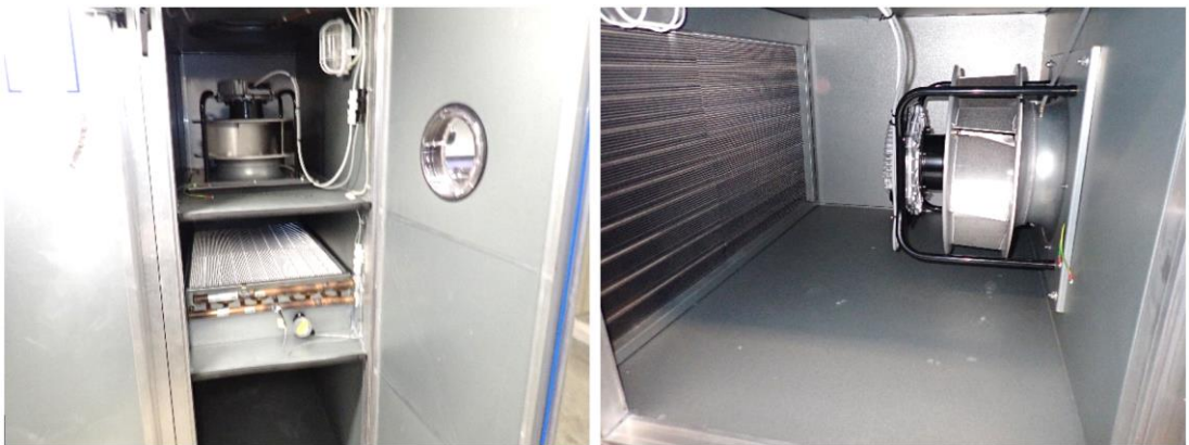
Kuva 129. Yleiskuvat iv-koneiden puhallinkammioista. Puhaltimet ovat suoravetoisia ja niiden energiatehokkuus on siten hyvä. Aistinvaraisesti puhaltimien toiminnassa ei havaittu puutteita. Kammiot ovat puhtaita.
