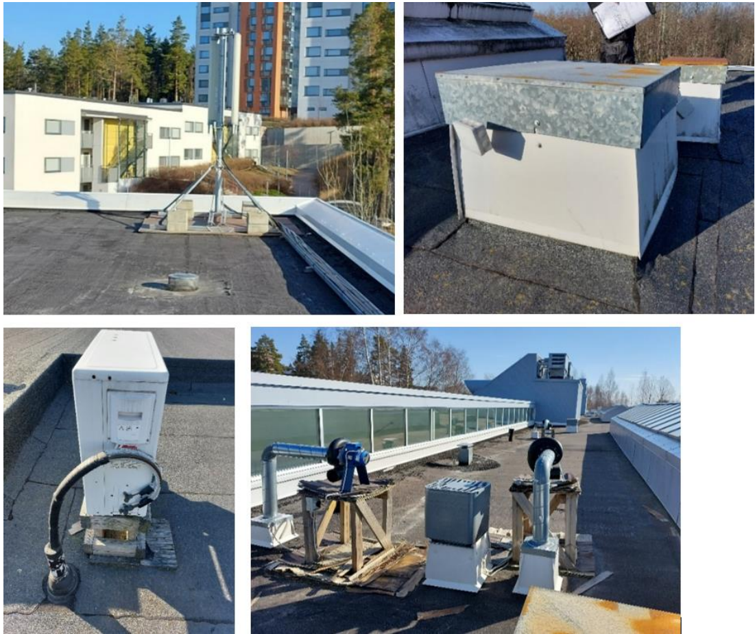
Kuva 105. Alkuperäisellä osalla on runsaasti erilaisia taloteknisiä asennuksia asennettuna suoraan bitumikermikatteen pinnalle, mikä rasittaa kermiä. Puiset kannatinrakenteet ovat paikoin lahot.
