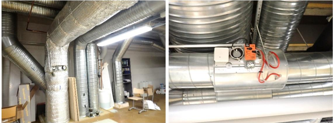
Kuva 225. Yleiskuvat iv-konehuoneen ilmanvaihtokanavista. Konehuoneen kanavistoissa on ilmamääräsäätimiä (oikea kuva, Fläkt Optivent).
