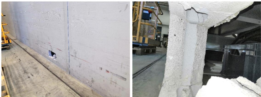
Kuva 199. Hallien 1085 ja 1075 välisestä väliseinästä on irronnut harkko. Vaurio on mekaaninen.
