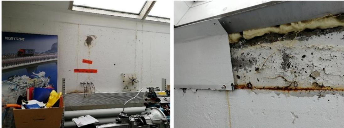
Kuva 28. Aktiivinen ikkunaliitoksen vesivuoto opetustilassa 131 (111A). Vuoto on kastellut maanvastaisia seinärakenteita. Kohtaan tehtiin rakenneavaus (RAK15a). Vuotoa tapahtuu joko ikkunan ja ulkoseinän liitoksesta ja/tai alumiinirakenteisen ikkunanprofiilien liitoksista.
