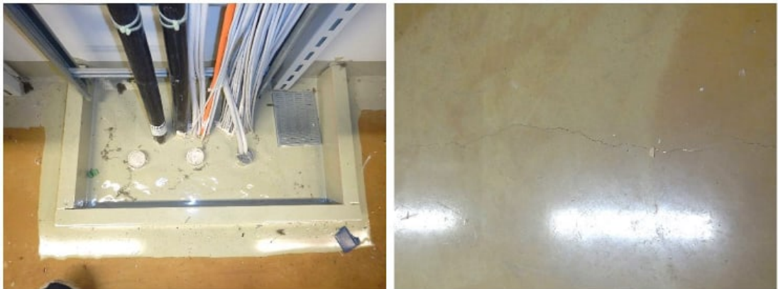
Kuva 179. IV-konehuoneen jalkalistat ja läpiviennit on toteutettu erillisellä pinnoitteella. Pinnoitteessa on paikoittain halkeamia.
