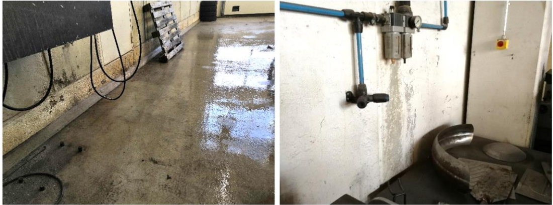
Kuva 56. Hallitilojen käytön aiheuttamaa maalipinnan hilseilyä autonpesutilassa 151 ja paikallisesti muilla hallien seinillä.
