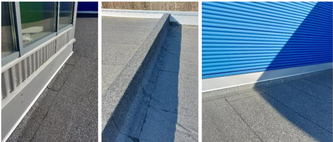
Kuva 209. Erilaiset ylösnostopellitykset olivat hyväkuntoisia. Paikoin ylösnostojen kermeissä oli pintakermi irti alustasta tai rityssä.
