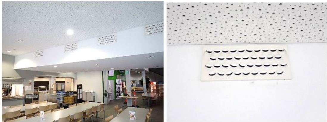
Kuva 238. Yleiskuva aulatilán ruokalasta. Tuloilmalaitteiden puhalluskuvio on asetettu täysin alaspäin.
