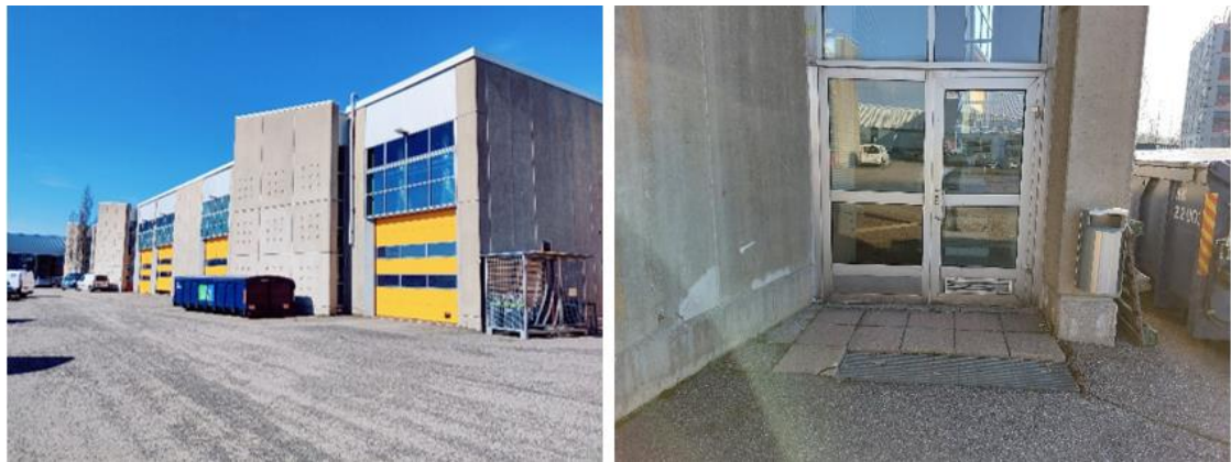
Kuva 2. Yleiskuva rakennuksen eteläseinustalta. Pääosin asfaltoitu piha-alue on kallistettu poispäin rakennuksesta. Julkisivun ulokkeiden ulko-ovien edustojen maankallistukset havaittiin riittämättömiksi.
