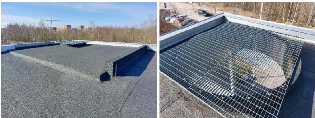
Kuva 204. Laajennusosan sisäänkäyntikatos (YP5). Katoksen valoaukko on peitetty metalliritiliköllä putoamisen estämiseksi.
