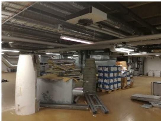
Kuva 216. IV-konehuoneessa on säilytyksessä akustiikkalevyjä, joissa on avointa mineraalivillapintaa. IV-konehuoneessa on yleisesti paljon tavaraa säilytyksessä.
