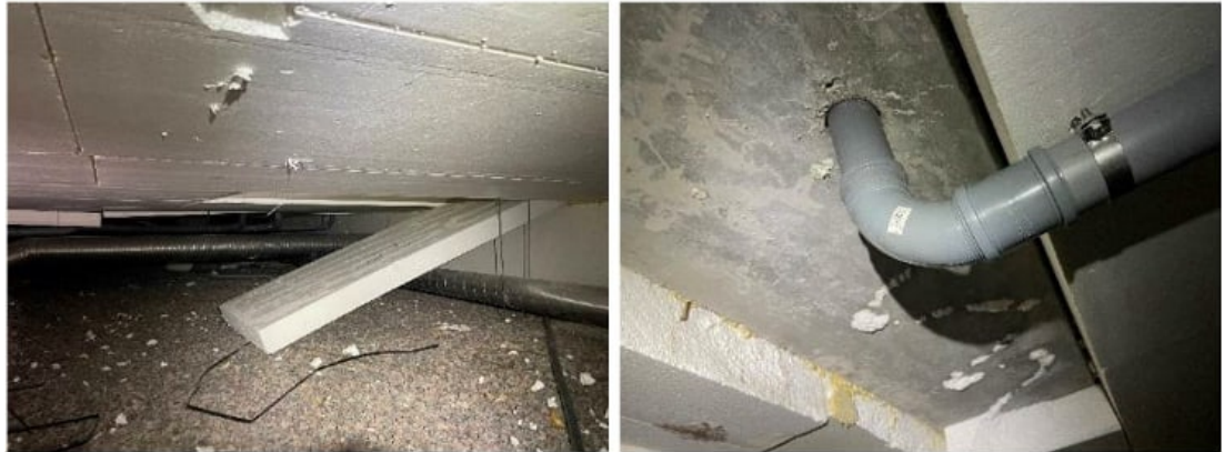
Kuvat 168. Alapohjan alapuolisia eristelevyjä on paikoin irronnut tai puuttuu kokonaan. Ryömintätilan katossa ja sokkelien sisäpinnassa on EPS-eristelevytys.
