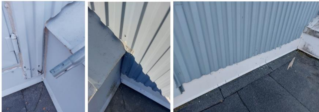
Kuva 107. Yleiskuvia peltikattojen liitoskohdista ja ylösnostopelleistä. Liitoskohtiin on asennettu tiivistysmassoja, jotka vaikuttivat tarkastushetkellä elastisilta ja kohtuullisen tiiviiltä.
