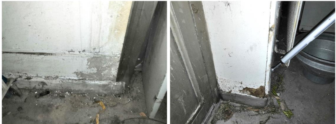
Kuva 58. Hallin 150 reunalla sijaitsevien toisarvoisten tilojen (145–148) ulkoseinien betoni- ja levyrakenteissa on kosteusjälkiä.
