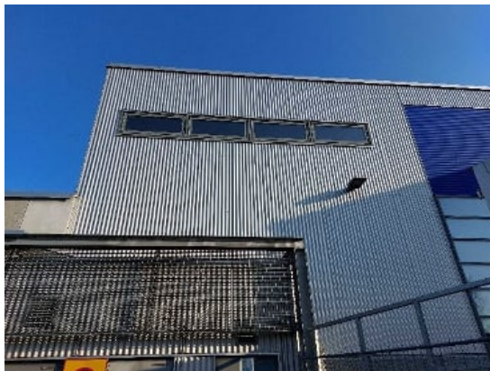
Kuva 189. Hallin 1099 Paroc-seinän vuotojälkien yläpuoliset savunpoistoikkunat ulkopuolelta.
