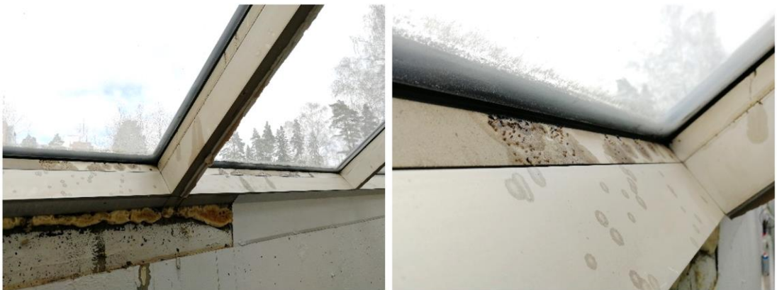
Kuva 66. Vinoikkunoiden alumiiniprofiilirakenteen ja ikkunalasin välistä tapahtuu vesivuotoa. Kuvat tilasta 131 (111A).
