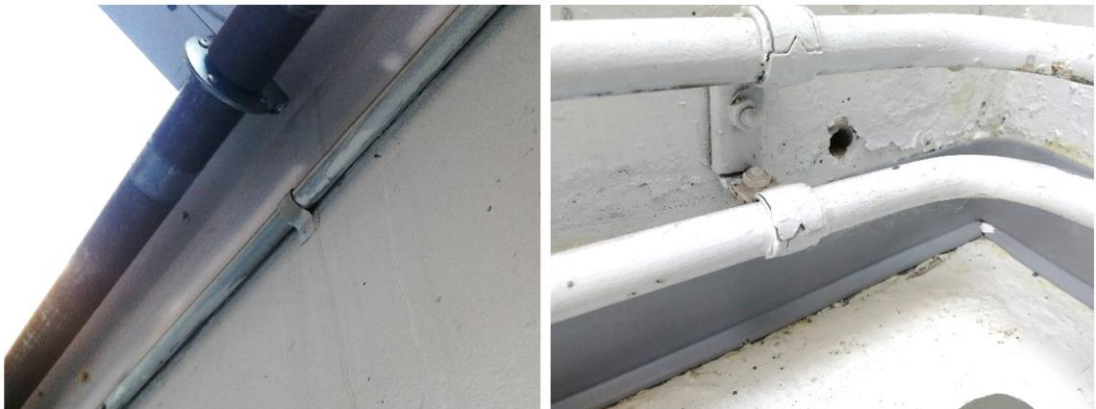
Kuva 31. Tilojen 188 (114) ja 139 (115) maanvastaisilla seinillä havaittiin vanhoja vähäisiä valumajälkiä kiinteiden alumiini-ikkunoiden rakenneliitoksista. Maanvastaisissa seinissä havaittiin myös avonaisia reikiä ja vanhoja kosteusmittausreikiä, joista osasta oli ilmayhteys maaperään.
