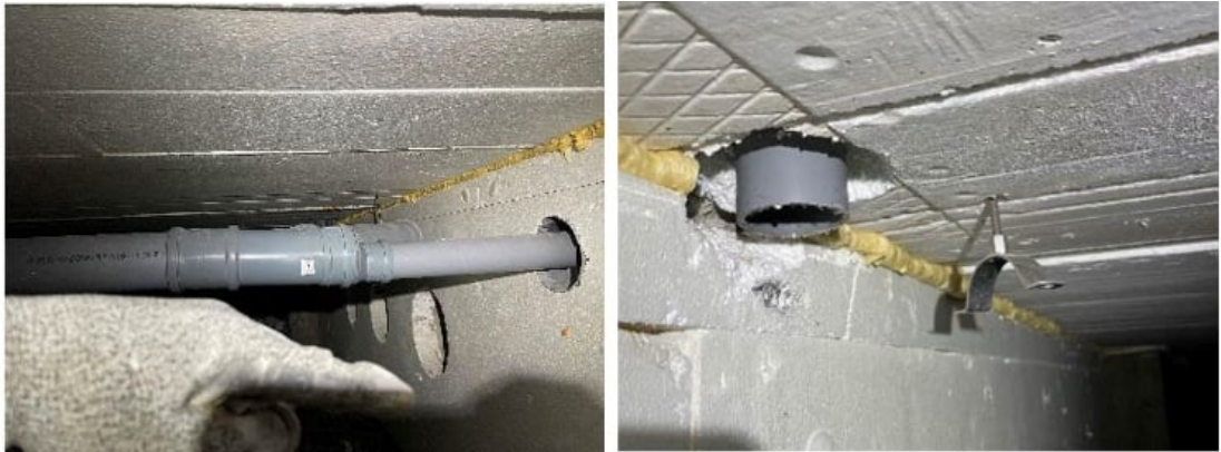
Kuva 174. Viemäreiden kaadot ovat paikoin tasaisia tai lievästi takakaatoisia. Yksittäisiä viemäreiden varauksia ei ole liitetty viemärilinjoihin.
