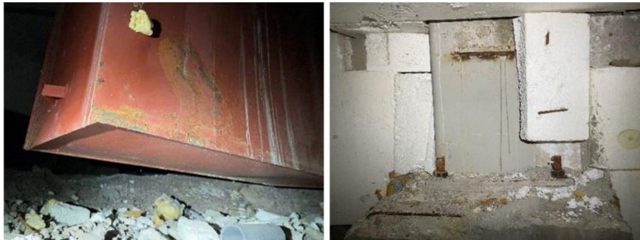
Kuva 171. Nostinten upotuskaukaloissa ja teräsrakenteisten pilareiden kiinnityksissä havaittiin ruostumista.
