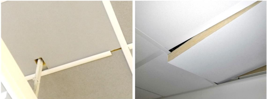
Kuva 120. Akustiikkalevyihin tehtyjä reikiä ei ole pölynsidontakäsitelty. Joissakin tiloissa (mm. auditorio 227, tilat 240 ja 251 (222) on uusitut alaslasketut alakatot, joiden levyjen reunat on valmiiksi pinnoitetut, mutta myöskin näiden leikatut reunat ovat pinnoittamattomia.
