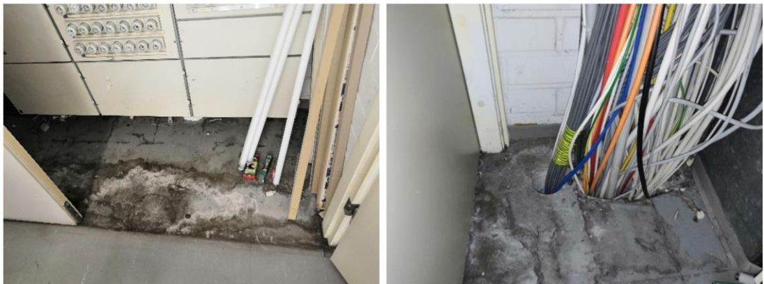
Kuva 44. IV-konehuoneen porrashuoneen 214 vieressä olevan sähkökaapin lattialla oli siivousvesien jälkiä. Tilan välipohjassa on avonaisia läpivientejä. Avonaisia läpivientejä on myös muualla välipohjan alueella. Epätiiviitä läpivientejä on 1.-2. kerroksen välisen välipohjan lisäksi 2. kerroksen ja IV-konehuoneiden välisissä välipohjissa. Avoimet läpiviennit voivat vaikuttaa rakennuksen paloturvallisuuteen.
