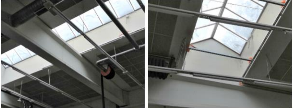
Kuva 115. Vuotojälkiä korjaamotilojen alkuperäisissä kattoikkunoissa.
