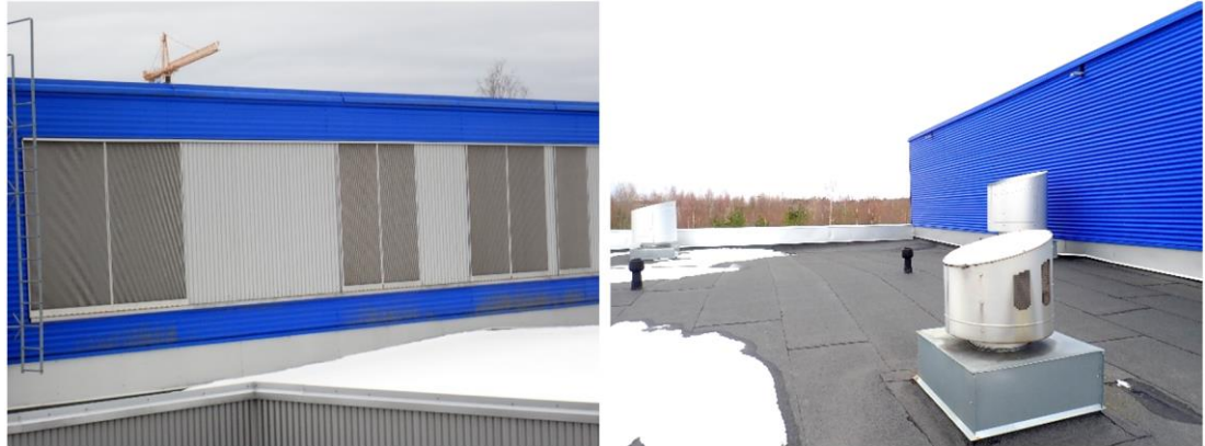
Kuva 219. Vasemmanpuolisessa kuvassa on iv-koneiden ilmanotto ja oikeanpuolisessa kuvassa poistoilman puhalluksia.
