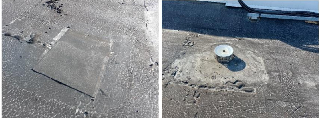
Kuva 99. Alkuperäisen osan kermissä on halkeilua, kuplimisjälkiä sekä paikkakorjauksia.
