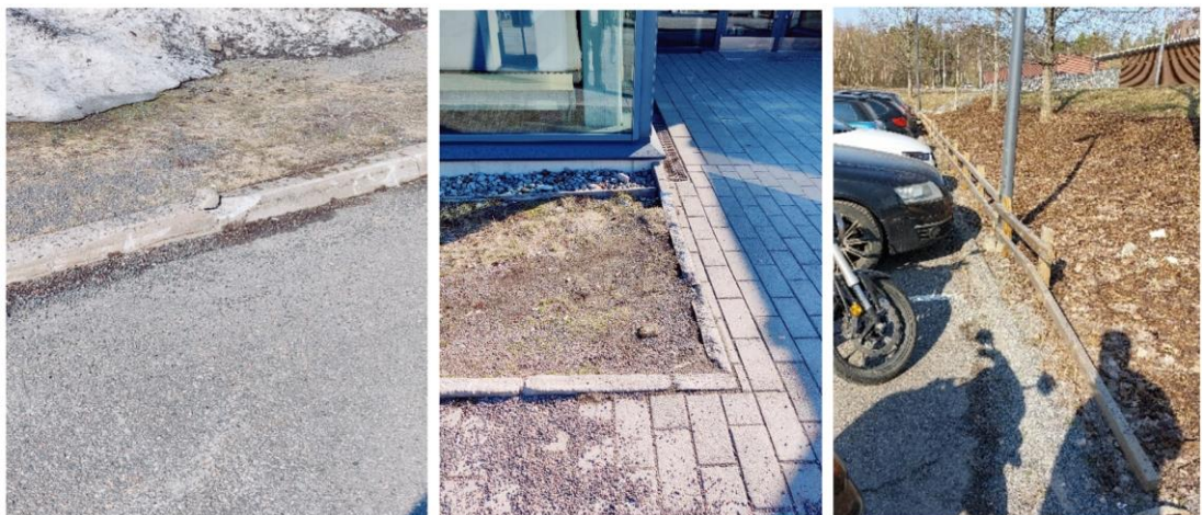
Kuva 153. Paikoin havaittiin kolhiintuneita katu- ja reunakiveyksiä piha-alueilla. Rakennuksen luoteisnurkan pysäköintialueella havaittiin vaurioitunut koristeaita.
