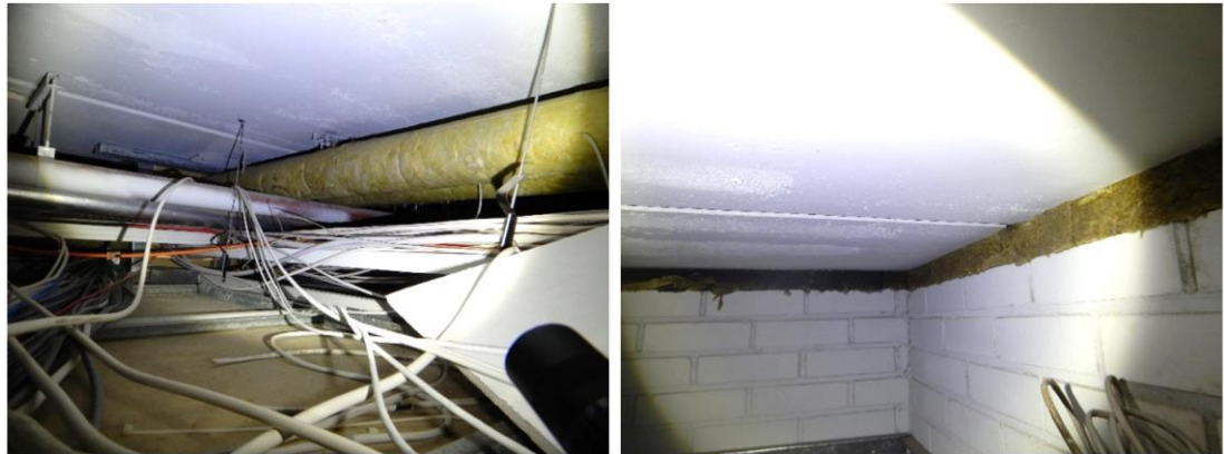
Kuva 122. 2. kerroksen käytävän 235 alakatossa on putkia, joissa on eristeenä pinnoittamaton mineraalivilla ja väliseinien ja yläpohjan liitoksiin on lisätty pinnoittamaton mineraalivillakaista.
