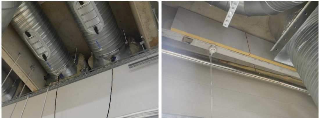
Kuva 215. IV-konehuoneessa on reunoiltaan pinnoittamattoman akustiikkalevyt ja putkieristeiden päitä, joissa on avointa mineraalivillapintaa.
