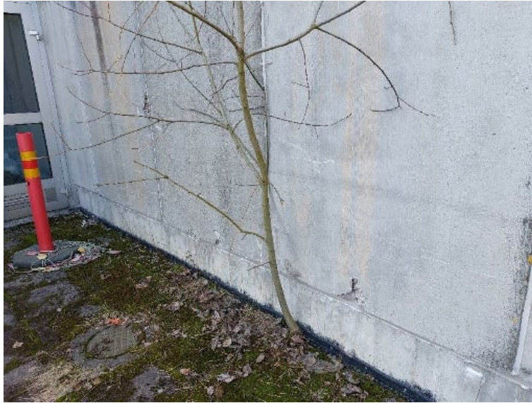
Kuva 8. Rakennuksen liikuntahallin seinustalla havaittiin sokkelissa kiinni kasvava puu. Kuvassa näkyy maanpinnan rajassa perusmuurilevyn kiinnityslista.
