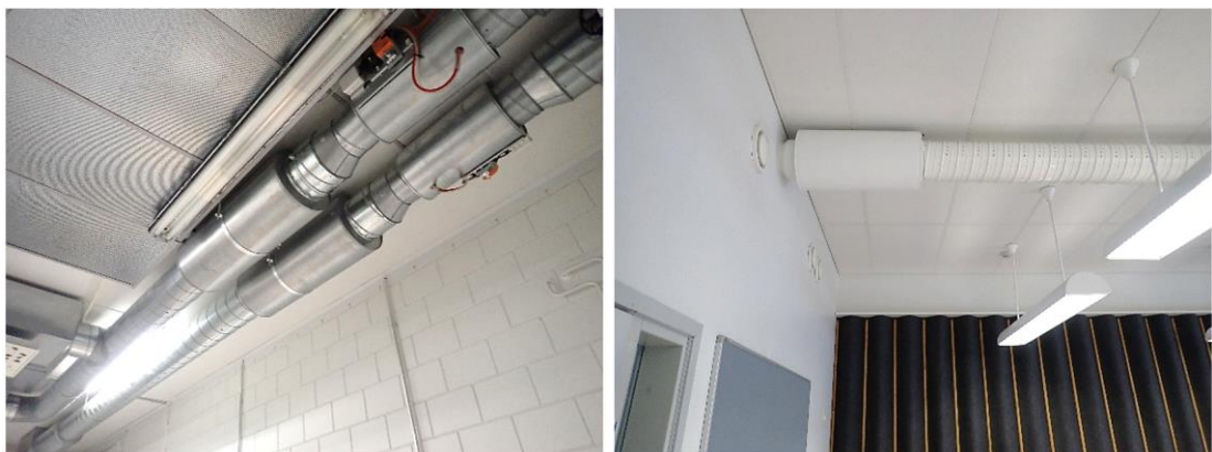
Kuva 227. Yleiskuva opetustilan ilmanvaihtokanavistoista. Kanavissa on äänenvaimentimet (vaimennusmateriaali on polyesterikuitu) ja ilmamääräsäätimet (vasen kuva, Fläkt Optivent).
