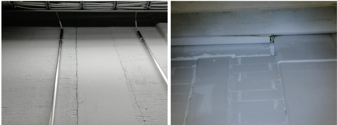
Kuva 236. Hallin 1041 ja aulan välisen seinän pilareiden ja harkkorakenteen liitoksissa on halkeamia. Seinän ja yläpohjan liitoksessa on myös epätiiveyskohtia. Havainnot hallitilan puolelta.
