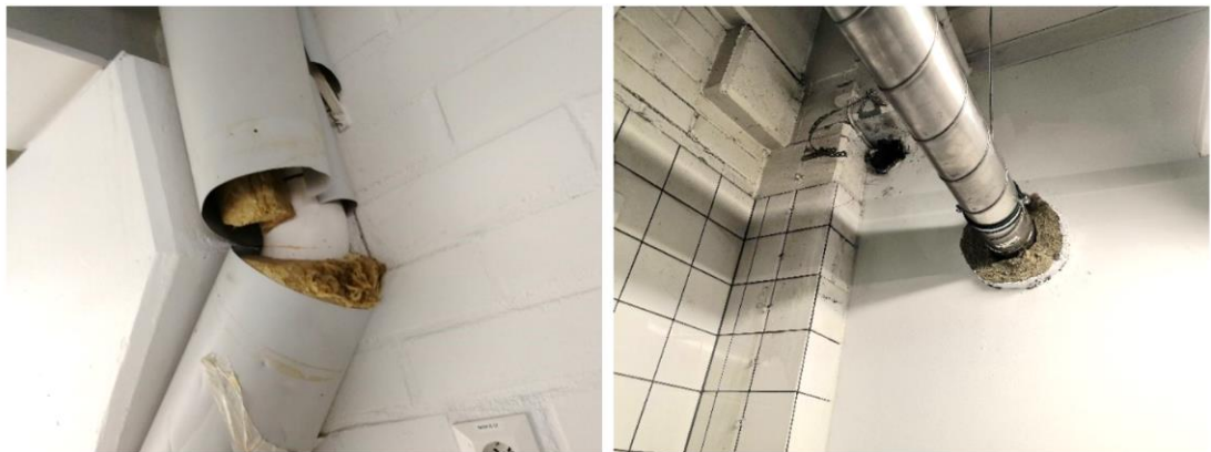
Kuva 121. Tiloissa on putkieristystyksiä, joiden päissä mineraalivillaeriste on avoin sisätiloihin.
