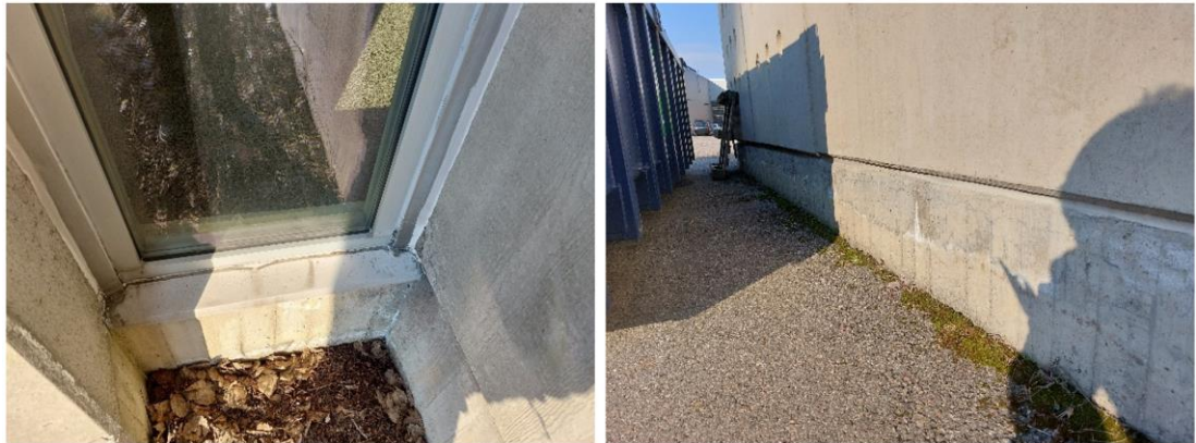
Kuva 60. Hallien välisten porrashuoneiden vesipeltien kallistuksessa ja massauksessa on puutteita. Sokkelin ulkopinnassa on kalkkihärmää ja halkeamia erityisesti hallien välisten porrashuoneiden ulkoseinissä.
