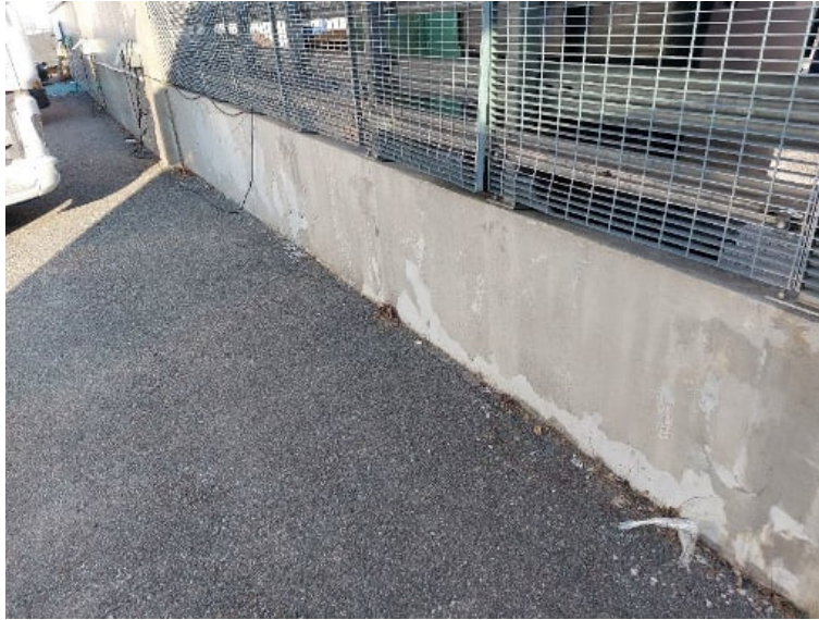
Kuva 148. Rakennuksen itäsivun eteläpäässä havaittiin betonirakenteiden aidan rappausten hilseilevän.
