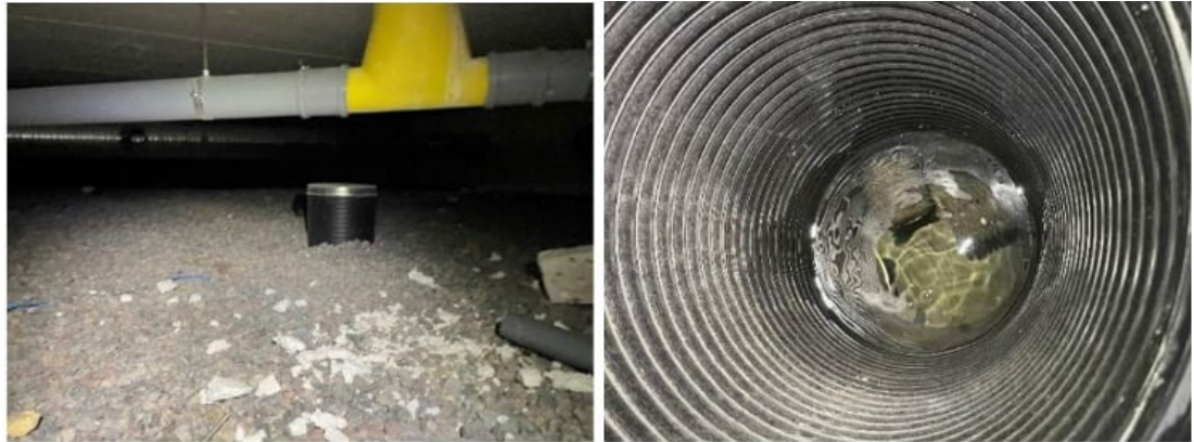
Kuva 176. Ryömintätilassa havaittiin salaojien tarkastuskaivoja, joita avattiin pistokoeluonteisesti. Kahdessa linjassa (useammassa tarkastuskaivossa) havaittiin vedenpinnan olevan liian korkealla, putket olivat vedenpinnan alapuolella.
