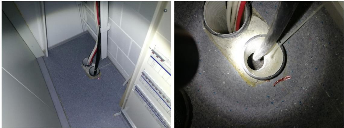
Kuva 164. Sähkökaappien ja nousukeskuksen sähköjohtojen varausputket ovat avoinna ryömintätilaan. Läpivienneistä havaittiin voimakas ilmavirtaus sisälle päin. Sähkökaapeissa oli avoimia läpivientejä käytävän alakattotilaan. Ilmayhteys vaikuttaa myös alapohjan paloluokitukseen ja paloturvallisuuteen.
