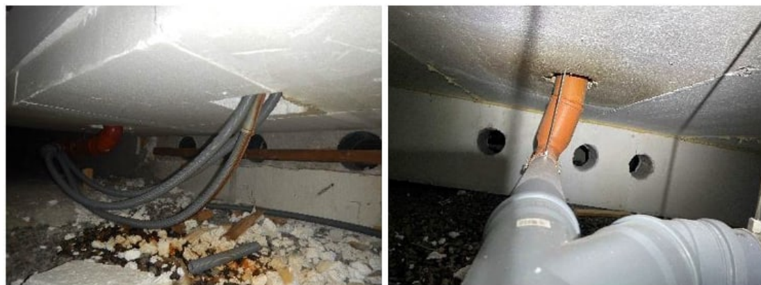
Kuva 173. Autonostinten ja viemäreiden tarkastuskaivojen läheisyydessä on paikoin toiminnasta aiheutuvia vuotoja ryömintätilaan.
