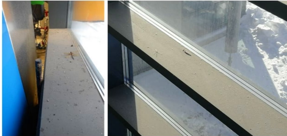
Kuva 217. Hallitilojen ja aulatilán 1002 teräsprofiilijulkisivun vaakapinnoilla oli pölyä ja roskaa.
