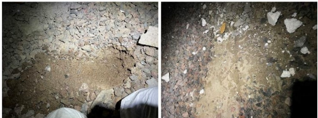
Kuva 169. Alustäytön pintakerroksessa, sepelitäytön alla, on paikoin hienoainesta. Alustäytössä on alueita, joiden pintakerros koostuu pääosin hienoaineksesta.
