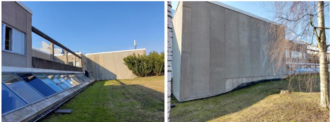
Kuva 5. Rakennuksen pohjoissivulla maan pintarakenteena on nurmikko. Maan pinnan kallistukset rakennuksesta poispäin havaittiin puutteellisiksi.
