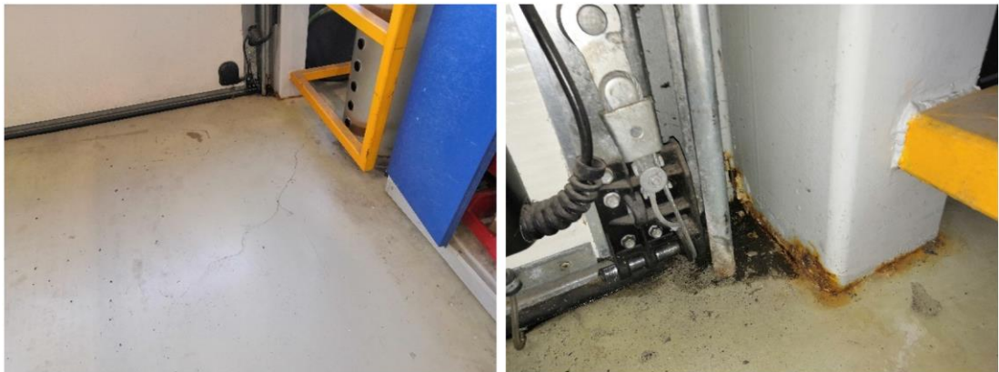
Kuva 191. Hallin 1102 nosto-ovien teräsrakenteiden alaosa on ruostunut hallitilojen käytössä lattialle päässeestä vedestä.
