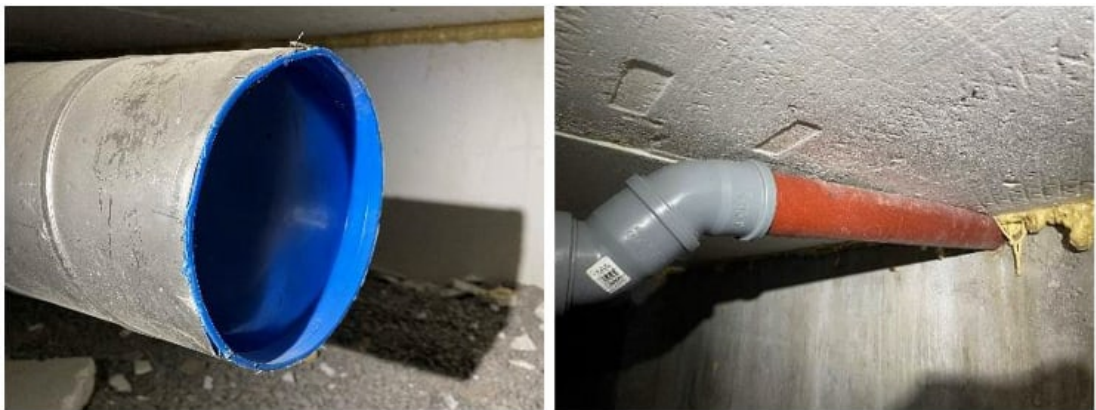
Kuva 175. Yksittäinen ilmanvaihtokanavan päähän jätetty rakennusaikainen muovitulppa (kanava päättyy). Valurauta- ja muoviviemäriin liitoksessa ei havaittu jatkoyhdettä eikä kannakointia.
