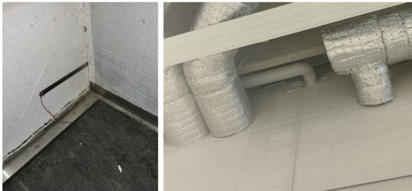
Kuva 235. Hallin 1041 ja aulan välisen seinän nurkka on haljenneet halliin päin. Havainto aulatilan puolelta. Hallin seinän pinta on slammattu, mutta se ei ulotu seinän yläosaan. Seinän yläosassa harkkoja ei ole puhtaaksimuurattu. Seinässä on pilareiden ja harkkorakenteen liitoksissa halkeamia. Seinässä on lisäksi läpivientejä, jotka ovat mahdollisesti epätiivittä. Havainnot hallitilan puolelta.
