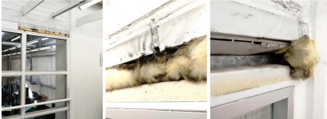
Kuva 88. Hallin 176 ja käytävän 235 väliseinän ikkunan liitokseen tehtiin rakenneavaus RAK4 irrottamalla ikkunan peitelista. Liitoksessa on mineraalivillaa, jossa havaittiin runsaasti ilmavirtausjälkiä. Liitoksessa on hallin puolella peltinen peitelista ja liitos on täysin epätiivis.
