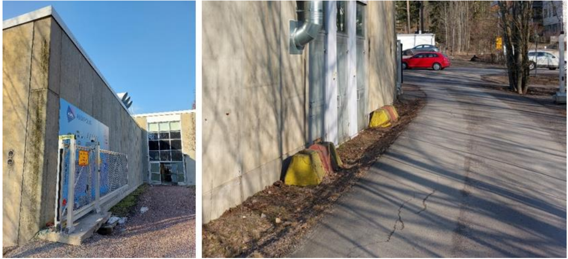
Kuva 4. Rakennuksen itäpäädyssä maankallistukset havaittiin puutteellisiksi. Itäpäädyssä maan kallistus on rakennukseen päin, ja tien pintarakenteen korkeusasema sokkelin yläpinnan tasoa korkeammalla.
