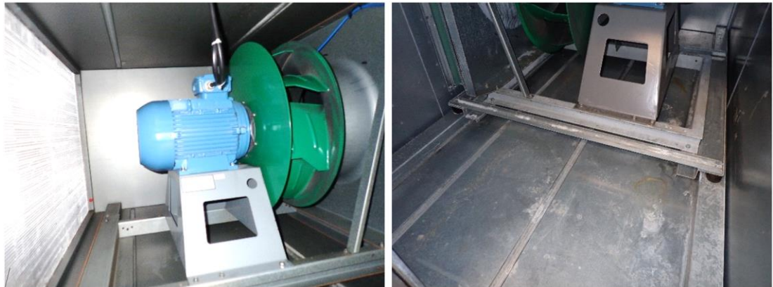
Kuva 223. Yleiskuvat puhallinkammiosta. Puhaltimet ovat suoravetoisia ja niiden energiatehokkuus on siten hyvä. Aistinvaraisesti puhaltimien toiminnassa ei havaittu puutteita. Poistoilmakammiot ovat hieman likaisia ja koneiden kammioiden havaittiin paikoin kalkkeumaa ja korroosiota.
