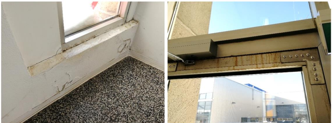
Kuva 59. Kosteusvauriojälkiä hallien välisessä porrashuoneessa, joka on toisarvoinen tila. Ulkoseinässä olevan kosteusvaurion kohdalla on katvealue, johon lumi pakkautuu ja tutkimushetkellä lunta oli seinää vasten ikkunaan saakka. Kosteusvauriot ulkoseinässä johtuvat mahdollisesti lumesta ja/tai epätiiviyistä ikkuna- ja oviliitoksista. Porrashuoneen ulko-ovessa on vuotojälkiä ja ruostetta.
