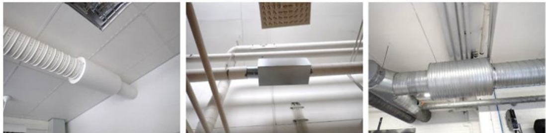
Kuva 133. Luokka-, opetus- ja käytävätilojen ilmanvaihtokanavistojen
