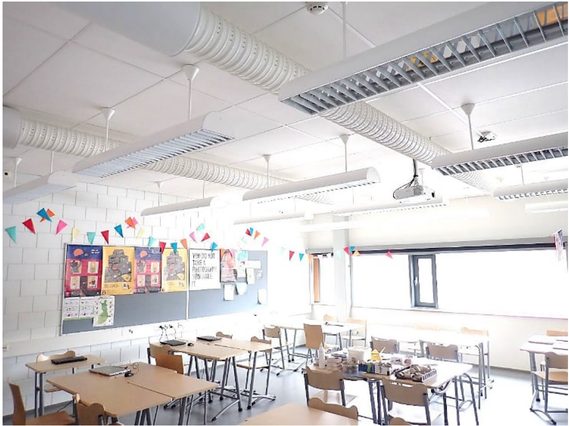
Kuva 137. Yleiskuva luokkatilan ilmanvaihdosta (luokka 203).
