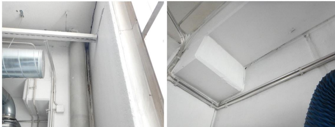
Kuva 68. Tilan 143 (141) nurkkaliitoksissa on halkeamia.
