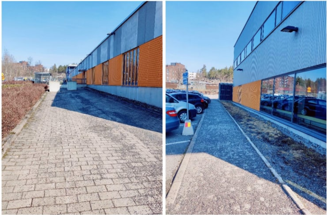
Kuva 152. Rakennuksen länsisivun maan pintarakenteena olevan kiveyksen havaittiin olevan pääosin hyväkuntoinen ja kaatavan pois päin rakennuksesta. Rakennuksen länsisivun pohjoispäässä havaittiin painunut nurmikkokaistale ja sokkeli on hyvin matala. Maanpinnan kallistukset pois päin rakennuksesta eivät ole riittävät.
