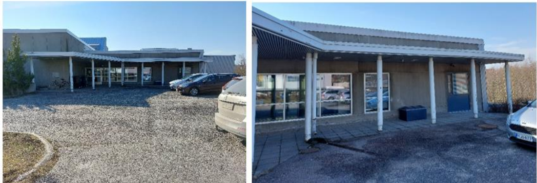
Kuva 10. Pääosin rakennuksen luoteisnurkan piha-alueiden kaadot havaittiin riittäviksi. Laatoituksen edustan asfalttialueella havaittiin viitteitä veden lammikoitumisesta. Sokkelin kosteusjäljet voivat viitata laatoituksen riittämättömään kaatoon poispäin rakennuksesta.
