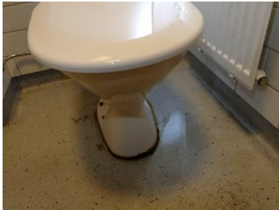
Kuva 162. Tilojen 1093 (104) ja 1090 välissä olevan WC-tilan pönttö vuotaa mahdollisesti. Lattialla oli vettä. Istuimen saumamassa on epätiivis.
