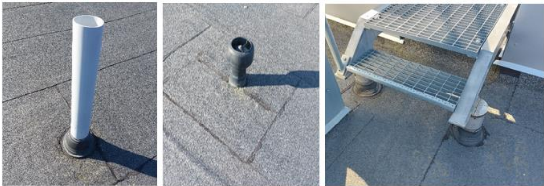
Kuva 207. Yleiskuvia laajennusosan läpivienneistä: muovinen viemäriputki ja sen EPDM-kumilaippatiiviste, alipainetuuletin ja portaiden jalustan läpivientien toteutus EPDM-kumilaipoilla. Kaikki läpiviennit olivat hyväkuntoisia.
