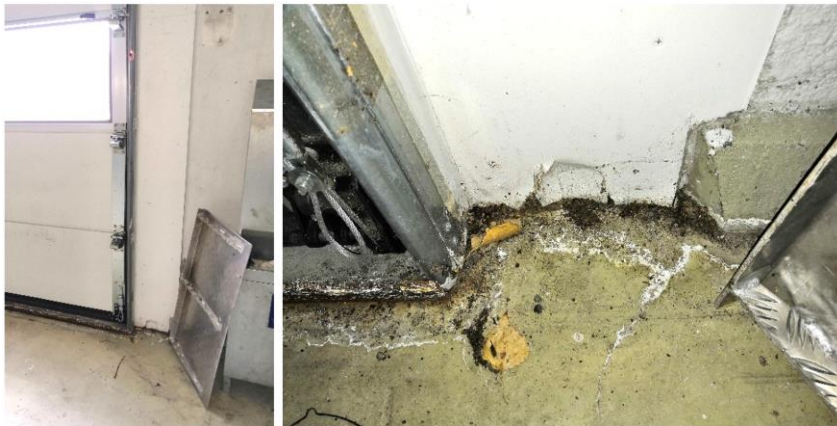
Kuva 57. Hallien ontelolaattarakenteisten ulkoseinäosuuksien ja nosto-ovien välissä on kipsilevyllä levytetty ulkoseinän kaistale. Levyjen alareunat ovat kosteusvaurioituneet.
