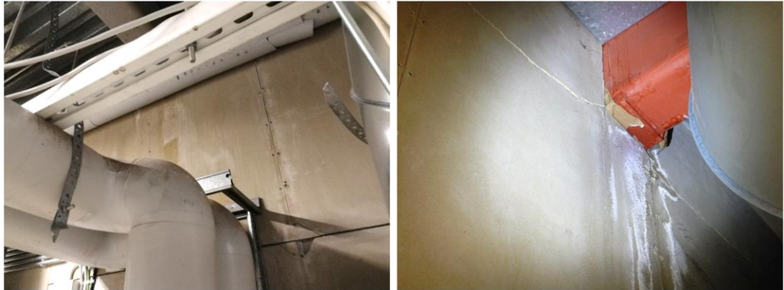
Kuva 70. IV-konehuoneiden ulkoseinien kuitusementtilevyissä on kosteus- ja vuotojälkiä. Julkisivussa on epätiivitä läpivientejä, joiden kautta seinärakenteeseen pääsee vettä.
