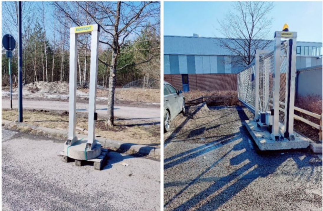
Kuva 151. Rakennuksen länsisivustalla olevalle pysäköintialueelle johtavalla tiellä on portti, jonka asennus vaikutti puutteelliselta.
