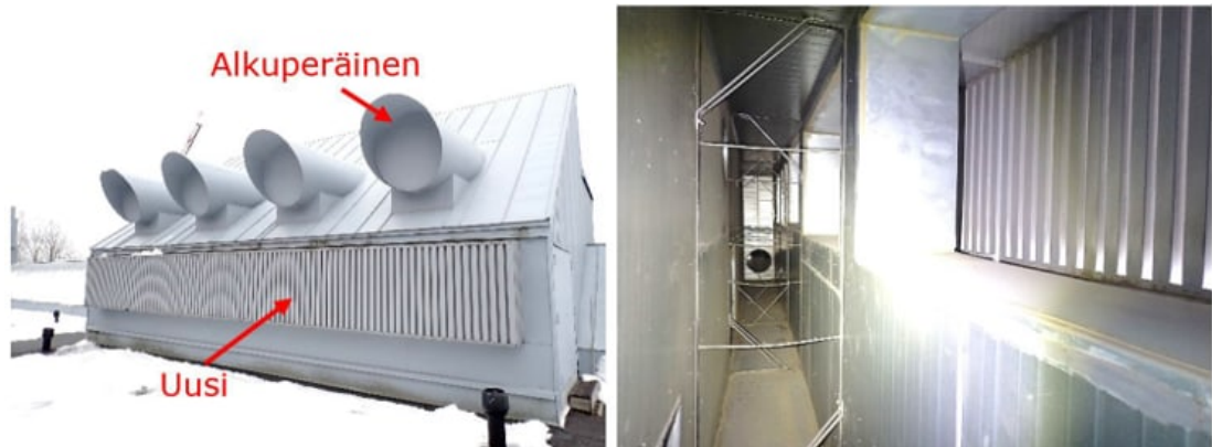
Kuva 123. Yleiskuvat rakennuksen iv-koneiden ulkoilmanotosta. Alkuperäiset ilmanotot on ummistettu ja tilalle on rakennettu lumisäleiköllä varustettu ilmanotto. Kammio on silmämääräisesti arvioituna sisältäpäin tiivis ja varustettu viemäröinneillä. Mineraalivillakuitumateriaaleja ei havaittu.
