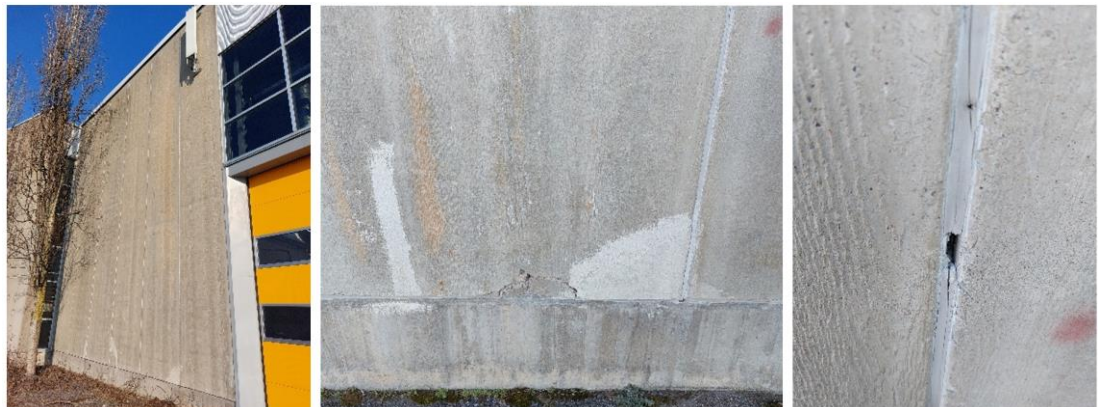
Kuva 61. Ontelolaattarakenteisten seinäosuuksien ulkopinnassa on elementin alareunassa paljon paikkauskohtia. Elementtien alareunaan kertynyt kosteus on todennäköisesti saanut reunat halkeamaan. Myös paikkaamattomia kohtia havaittiin. Joidenkin elementtien ulkopinnassa on halkeamia myös suuremmalla alueella. Näitä on rakennuksen sisäpihan puolella, joka on liikennöity. Osa halkeamista on todennäköisesti mekaanisia. Elementtien saumamassat ovat paikoin halkeilleet ja ikääntyneet, mutta massa on vielä jokseenkin joustavaa.
