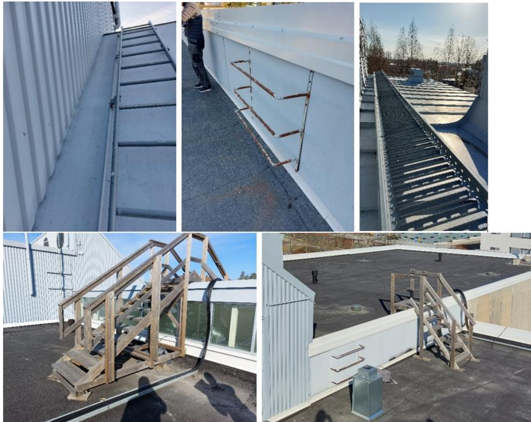
Kuva 108. Yleiskuvia alkuperäisen osan talotikkaista, kattoportaista ja puisista kulkusilloista, jotka olivat kuluneita, mutta toimivia. Kattoportaat on kiinnitetty puristuskiinnikkeillä peltikatteen hakasaumoihin (oikea kiinnitystapa).
