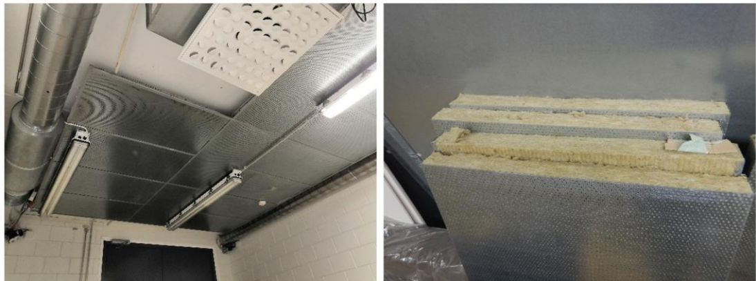
Kuva 213. Tilassa 1067 on akustiikkalevyt, joissa on rei'itetty teräslevy, jonka takana on pinnoittamatonta mineraalivillaa.
