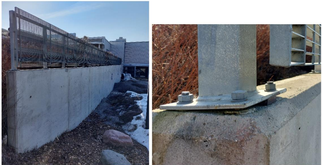
Kuva 155. Rakennuksen luoteisnurkalla havaittiin betonisen maanpainemuurin päällä teräksinen kaide, jonka pilarien alaosat olivat hieman kaltevat, ja aita oli oikaistu teräksisillä kiiloilla.
