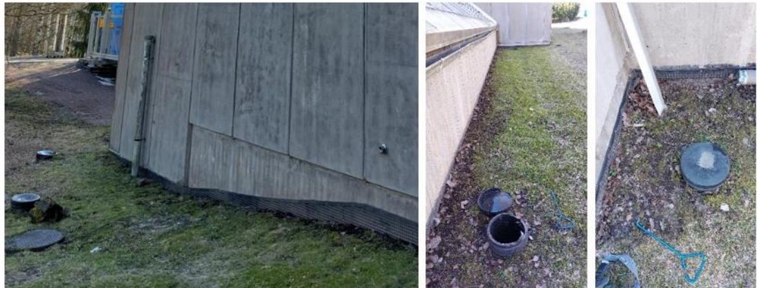
Kuva 6. Rakennuksen pohjoissivulla havaittiin muovisia salaojakaivoja ja perusmuurilevyt, jotka on lähtötietojen perusteella asennettu vuonna 2006. Rakennuksen pohjoissivun salaojakaivojen kansien havaittiin olevan paikoin vaurioituneita.
