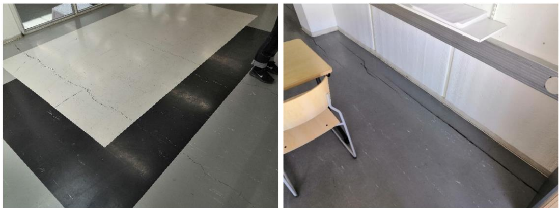
Kuva 42. 2. kerroksen käytävän 235 ja tilan 224 (208) lattiassa on halkeamia. Käytävällä halkeamia on useita ja tilassa 224 (208) halkeama on syvä. Rakennuksessa ei ole todennäköisesti riittävästi rakenteellisia liikuntasauvoja.
