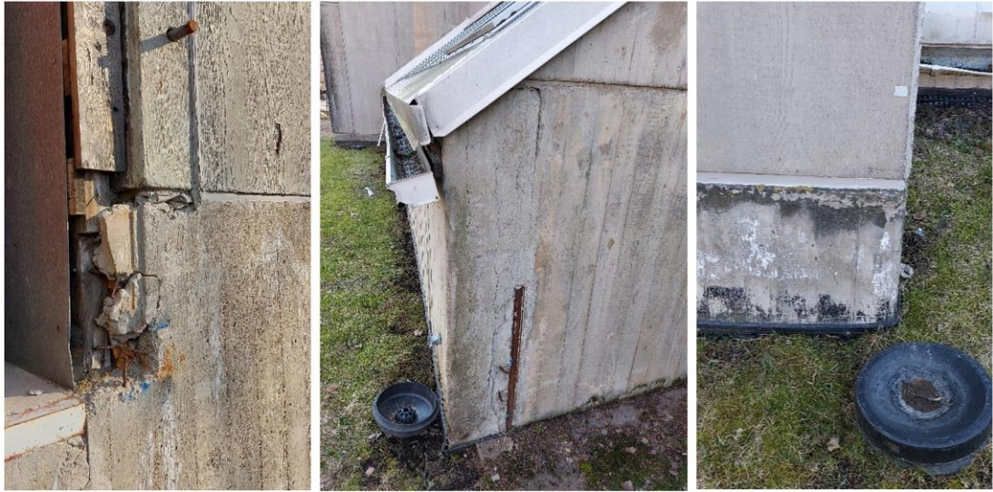
Kuva 62. Betonirakenteissa on vaurioita ja raudoituksia esillä muutamassa paikassa. Sokkelipinnassa on paikoittain sammalta viheralueen puolella.
