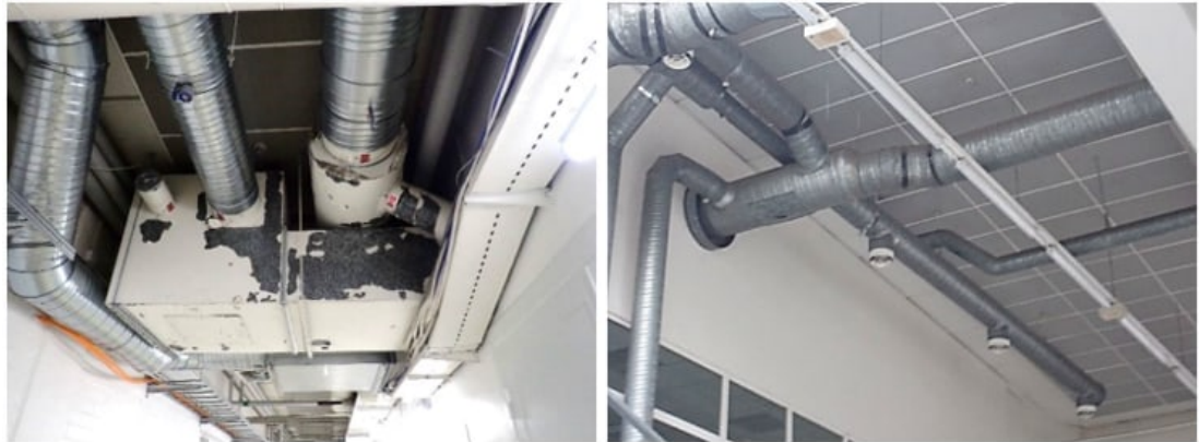
Kuva 134. Yleiskuvat vanhemmista iv-kanavista, joihin on liitetty uudempia kanavistoja. Kanavisto on silmämääräisesti osin tyydyttävässä kunnossa, mutta aistinvaraisesti niissä havaittiin ilmavuotoihin viittaavaa ääntä.
