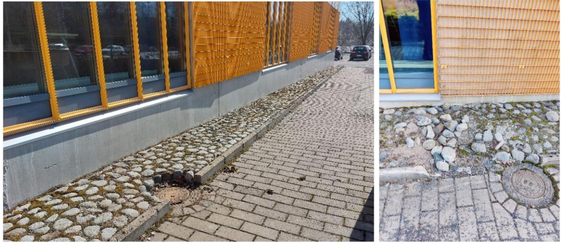
Kuva 154. Länsijulkisivulla oli useampi tarkastuskaivo, joissa oli vettä, mutta salaojaputkia ei ollut näkyvissä. Kaivot ovat todennäköisesti salaojan tarkastuskaivoja. Yksittäisessä paikassa rakennuksen länsisivulla havaittiin sokkelin viereisten kiveyksien vaurioituneen.
