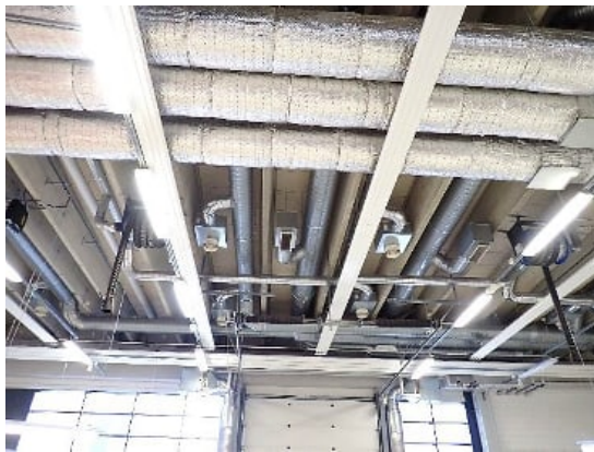
Kuva 226. Yleiskuva työhallien ilmanvaihtokanavistoista.
