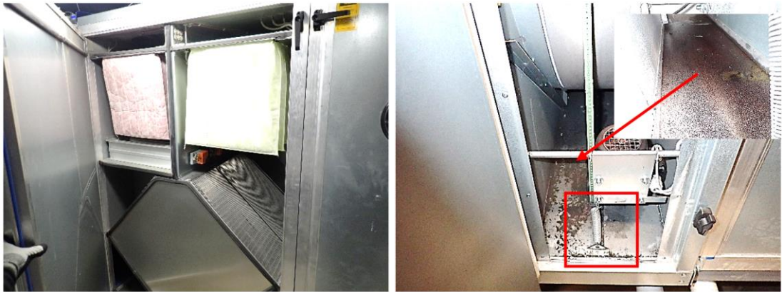
Kuva 128. Yleiskuvat lämmöntalteenotoista. Vasemmanpuolisessa kuvassa on vastavirtakenno ja oikeanpuolisessa kuvassa pyörivä lämmönsiirrin. Iv-koneiden TK312 ja 333 Ito- kammioiden pohjilla havaittiin likaa ja öljyä. IV-koneiden siirtimien moottoreissa ei havaittu laakerivaurioon viittaavia sivuääniä, mutta siirrintä pyörittävä hihna oli paikoin löysällä ja moottori makasi sen kiristysjousen varassa (merkattu punaisella).
