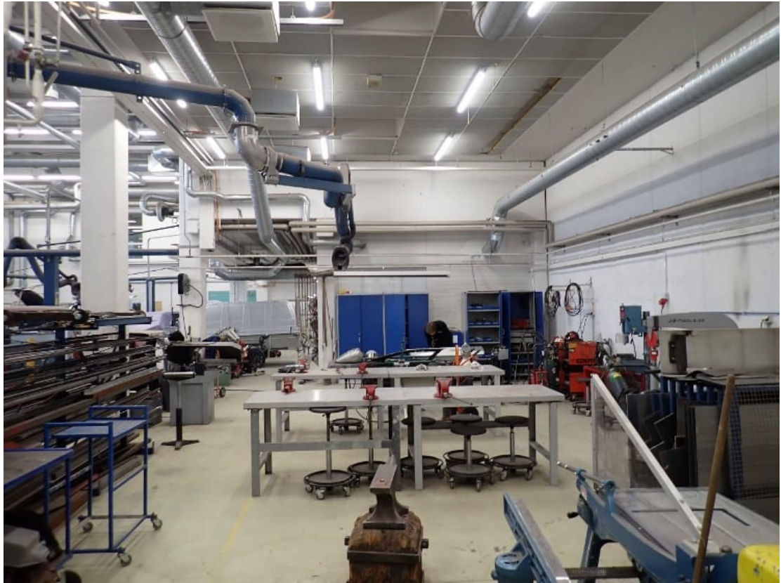
Kuva 139. Yleiskuva työsalin 150 ilmanvaihdosta. Työpisteiden /-alueen tuloilmalaitteet on sijoitettu ylös ja niiden sijoittelu sekä malli ei ole täysin optimaalinen tilan käyttöön nähden.
