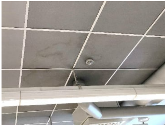
Kuva 116. Akustiikkalevyn vesivuotojälki luokassa 233 (215), fysiikka ja kemia.
