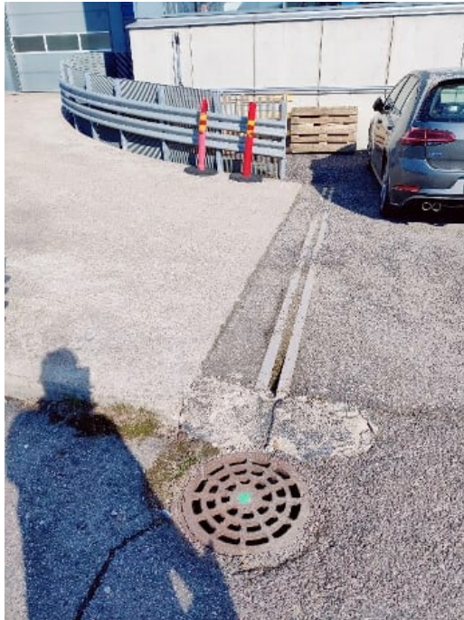
Kuva 149. Rakennuksen eteläsivun lastauslaiturin rampin edustan vesikourun havaittiin tukkeutuneen.
