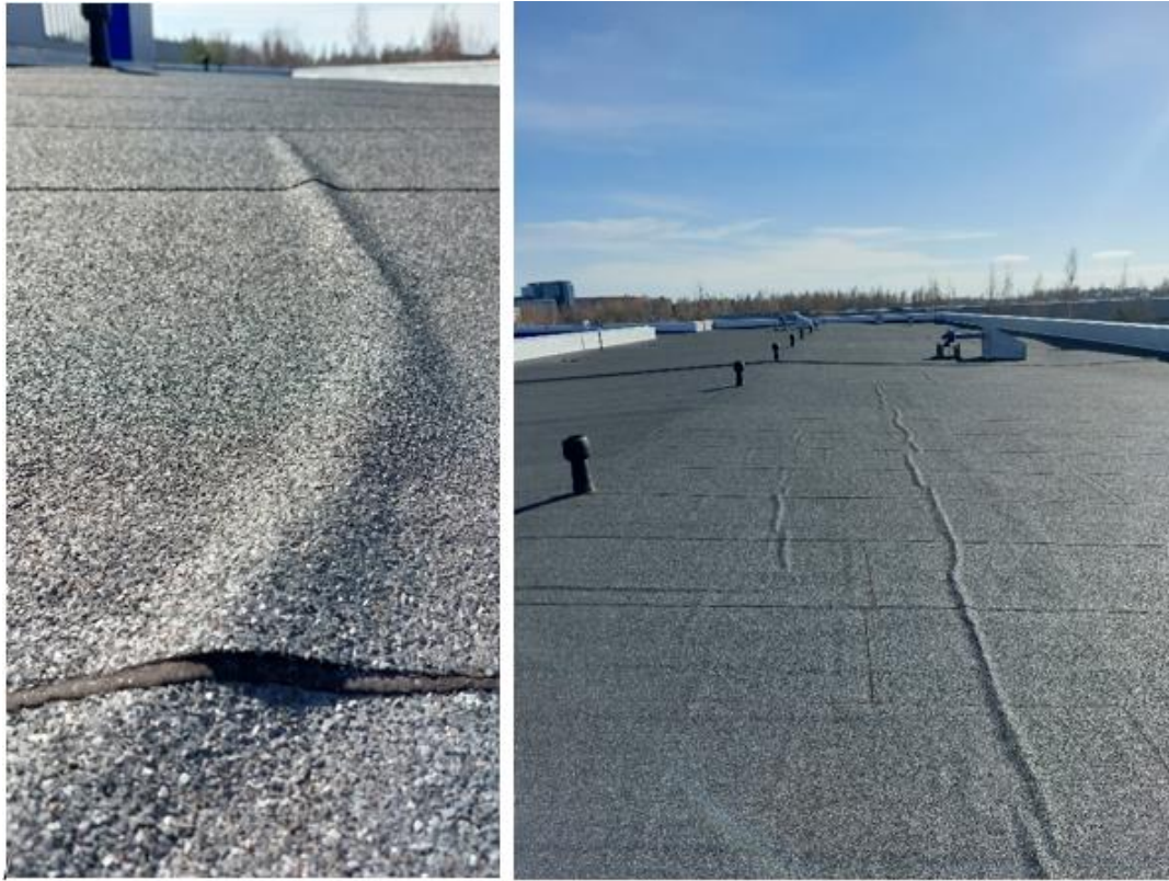
Kuva 206. Laajennusosalla pintakermi on paikoin poimuttunut ja saumoissa pintakermit ovat yksittäisissä kohdissa irti toisistaan. Vesi voi päästä pinta- ja pohjakerman väliin aiheuttamaan vaurioita.
