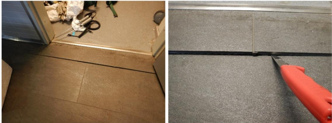
Kuva 166. Ruokailusalin 1003 lattialaatoituksen yksittäiset laatat ovat nousseet ja laastisauma on rikki varaston 1031.1 edessä.
