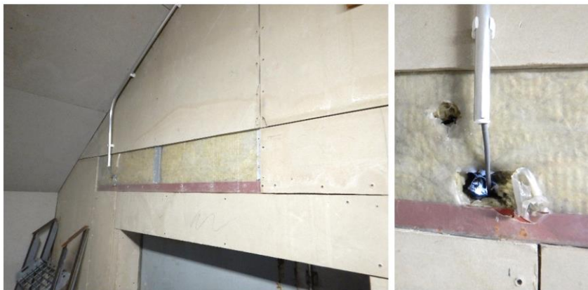
Kuva 71. IV-konehuoneen höyrönsulussa oli useita epätiivitä läpivientejä.
