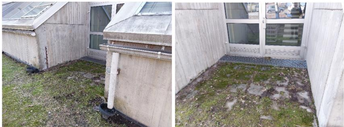
Kuva 7. Pohjoissivun ulko-ovien edustoilla olevat laatoitukset havaittiin sammaloituneiksi ja kaadot rakennuksesta pois päin riittämättömiksi.
