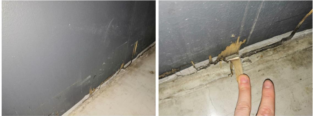
Kuva 190. Hallien teräsprofiiliulkoseiniä on levytetty alaosaan ja osassa levytys ulottuu lattiaan saakka. Levytyksessä on kosteusjälkiä hallitilojen käytössä lattialle päässeestä vedestä.
