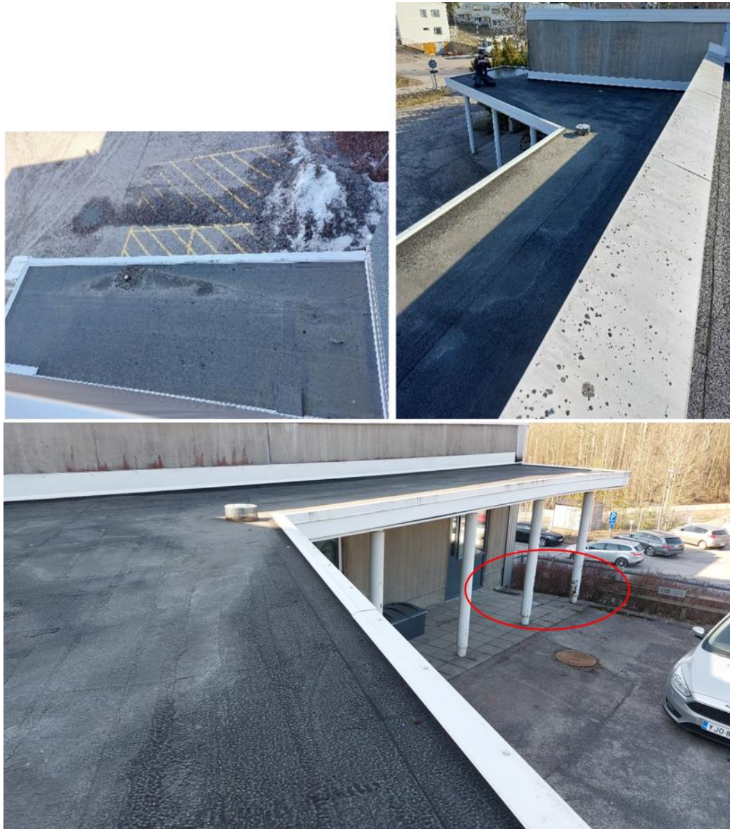
Kuva 102. Yleiskuvia alkuperäisen osan katosrakenteista. Kummankin katoksen bitumikerman päälle lammikoituu paikoin vettä. Kuvassa alla ympyröity punaisella nurkka, jossa maanpinta on sortunut ja katoksen kannatinpilari notkahtanut aiheuttaen nurkan painuimista ja veden kertymistä kermin päälle.
