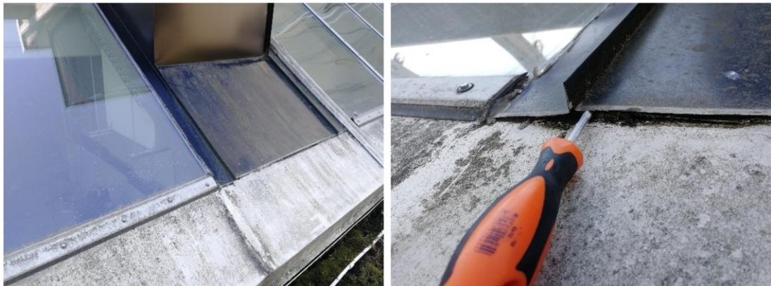
Kuva 29. Tilan 131 (111A) vuotokohta ulkopuolelta. Ikkunan viereisen levytetyn kohdan ulkopuolisen pellityksen liitokset eivät ole vesitiiviitä. Pellin alla on näkyvissä puulevy, jossa on kosteusjälkiä. Kiinteään ikkunan alumiinisen lasituslistan reunan elastiset saumamassaukset ovat kuluneet ja kohdalta puuttuu yhdestä lasielementtien liitoskohdasta butyyliteippi sekä lasituslista.
