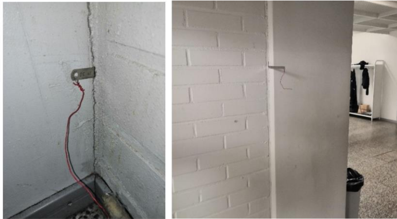
Kuva 232. Hallin 185 ja aulan välisen tiilirakenteisen seinän ja pilarien liitokset ovat haljenneet ja epätiivit. Havainnot aulatilan puolelta.
