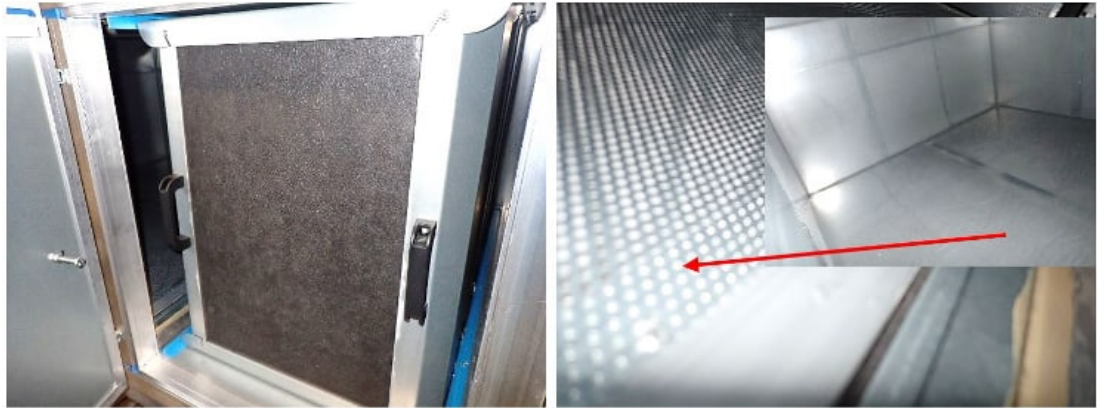
Kuva 130. Yleiskuvat iv-koneiden äänenvaimentimista ja puhalluskammioista. Äänenvaimennusmateriaali on polyesterikuitu ja kammiossa ei havaittu mineraalivillamateriaaleja. Kammiot ovat hyväkuntoisia ja puhtaita.
