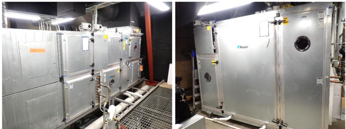
Kuva 125. Yleiskuvat vuodelta 2018 olevista ilmanvaihtokoneista.
