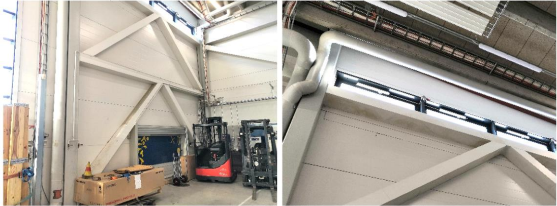
Kuva 188. Vuotojälkiä hallin 1099 Paroc-rakenteisen seinän teräsrakenteiden levytyksessä rakennuksen eteläpäädyssä. Seinäosuuden yläpuolella on savunpoistoikkunoita.
