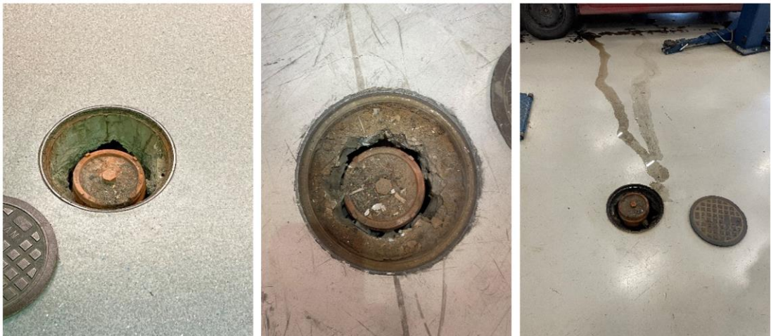
Kuva 165. Viemäriputken tarkastushaarojen lattialuukkujen läpiviennit ovat avoimia ryömintätilaan. Luukkuja on sekä hallitiloissa, että puhtaissa käyttötiloissa. Hallitiloissa vesi pääsee vuotamaan ryömintätilaan tarkastusluukkujen läpivienneistä. Ilmayhteys vaikuttaa myös alapohjan paloluokitukseen ja paloturvallisuuteen.
