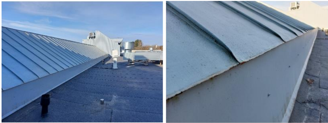
Kuva 106. Yleiskuvia peltikatoista. Reunoilla havaittiin alkavaa ruostetta.
