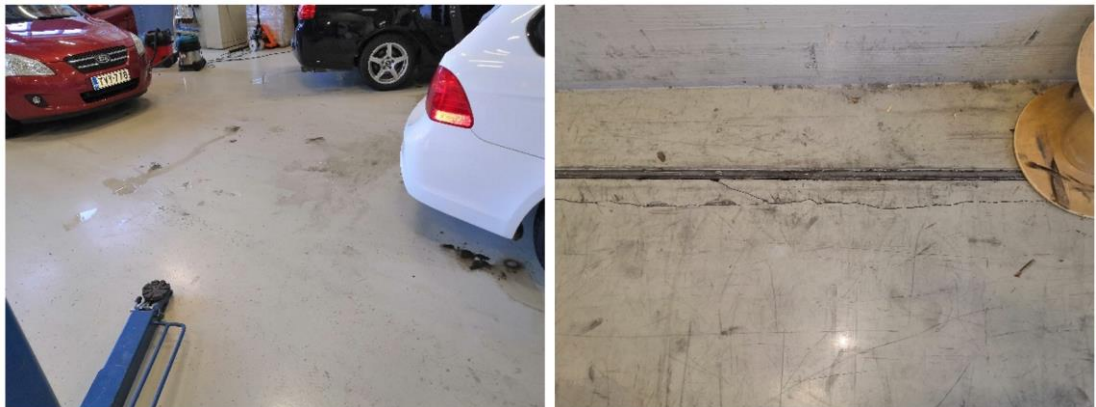
Kuva 161. Hallitilojen pinnoitteessa on paikallisesti säröilyä/halkeilua.
