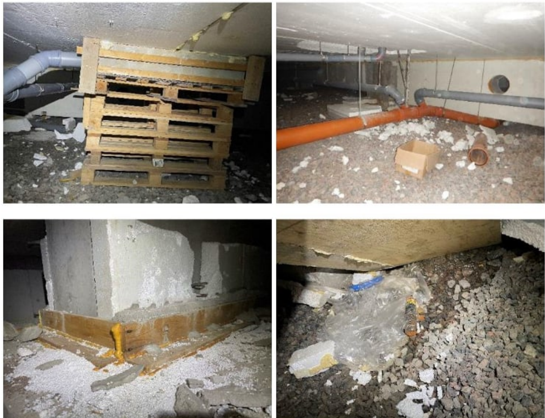
Kuva 167. Ryömintätilassa on monin paikoin rakennusjätettä (putkiosia, eristelevyjä, pakkausmuovia) ja paikoin myös orgaanista jätettä (pahvilaatikoita, kuormalavoja, muottilautoja ja -levyjä).
