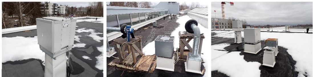
Kuva 131. Yleiskuvia vesikaton huippuimureista ja atex-puhaltimista. Poistoilmakojeet ovat pääosin uusittu vuonna 2018, mutta muutama 2000-luvun kojekin havaittiin. Vesikatolla on myös vanhempia, käytöstä poistettuja kojeita, joiden kanavointien ummistuksesta ei ole tietoa.
