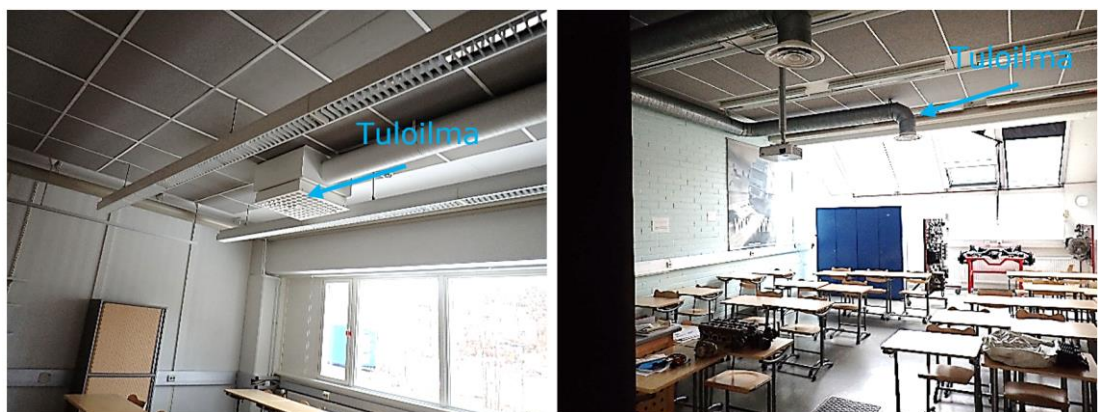
Kuva 138. Yleiskuva luokkatilojen ilmanvaihdosta (vasen kuva luokka 208 ja oikea kuva luokka 137). Vasemmanpuolisessa kuvassa on tuloilmahajottaja, jonka puhalluskuvio on säädettävissä. Oikeanpuolisessa kuvassa on hajottaja, jonka säätöominaisuudet ovat rajatut ja ne ovat
