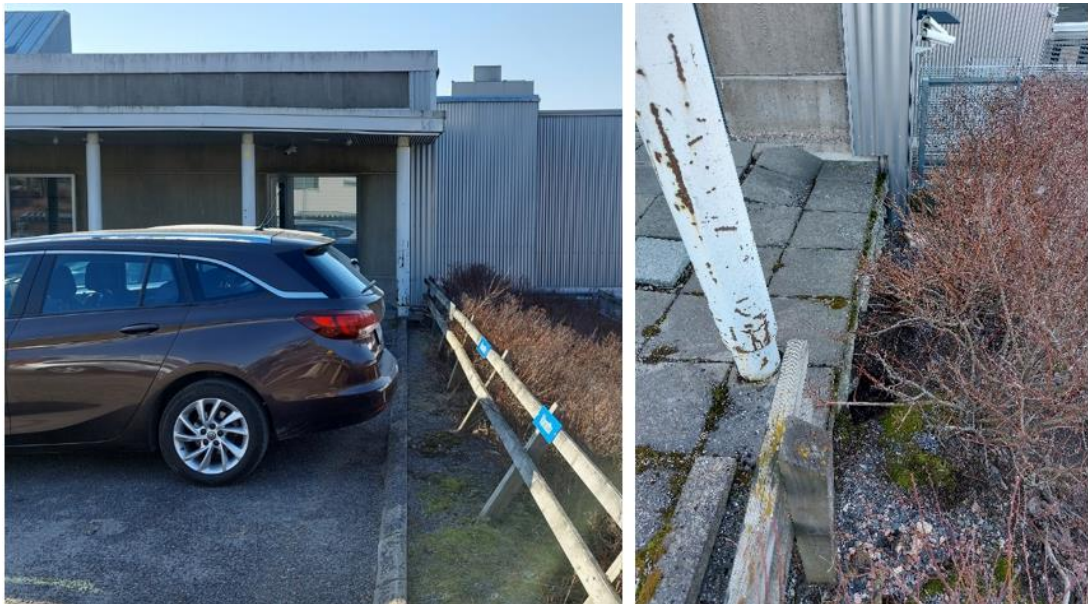
Kuva 11. Rakennuksen luoteisnurkalla koristeaita on kaatunut. Sisäänkäynnin edustan laatoitus ja sisäänkäyntikatoksen reunimmainen pilari on painunut, aiheuttaen katoksen nurkan notkahtamisen. Katoksen notkahtaneeseen nurkkaan lammikoituu vesikatolle vettä.
